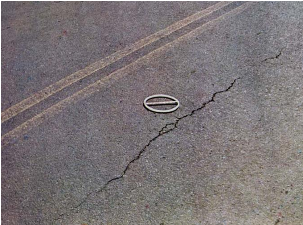
Figura 24: Trinca isolada do tipo longitudinal. Fonte: DNIT, 2003, p. 6
