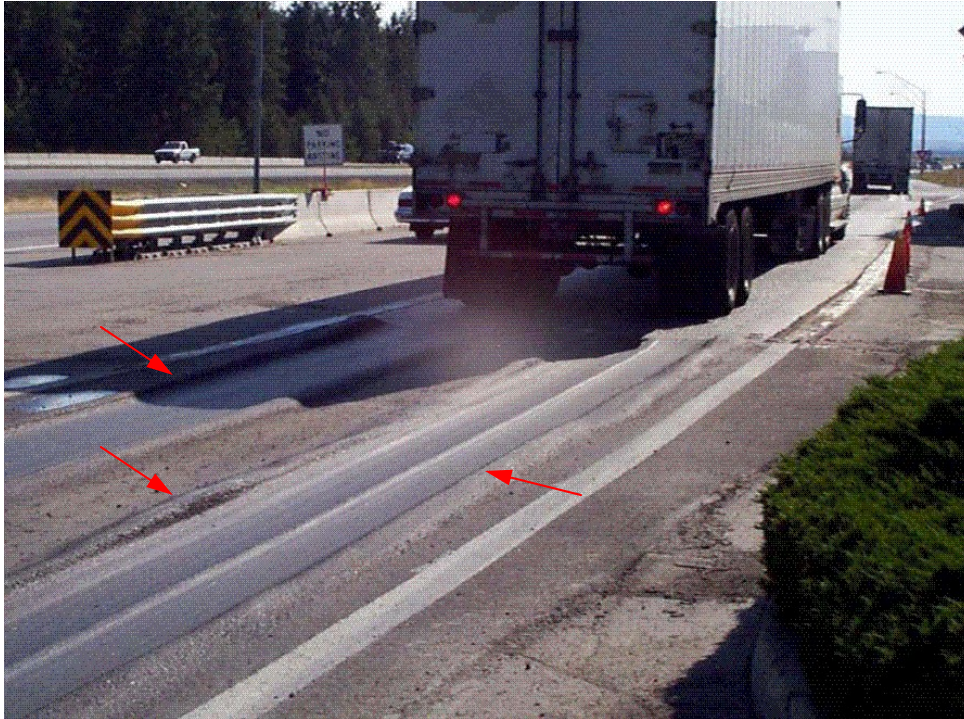
Figura 21: Exemplo real de deformação permanente. Fonte: Washington State Department of Transportation – Pavement guide
