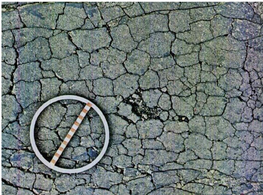
Figura 25: Trinca interligada do tipo couro de jacaré. Fonte: DNIT, 2003, p. 7
