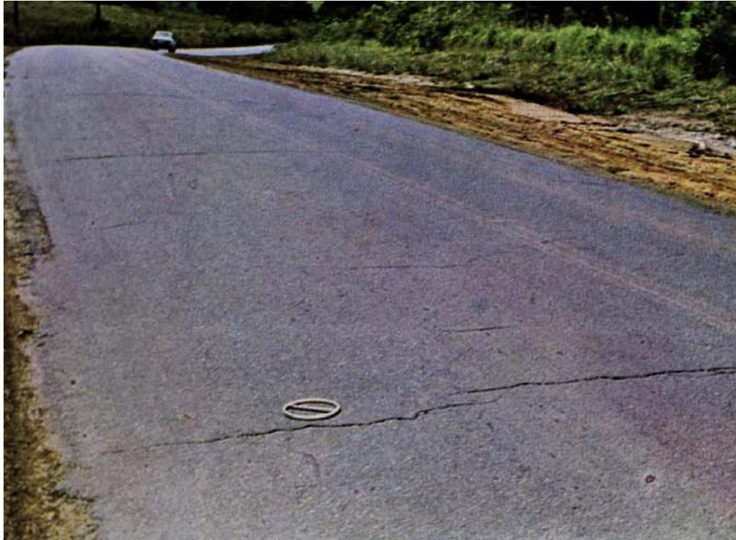
Figura 23: Trinca isolada do tipo transversal. Fonte: DNIT, 2003, p. 6
