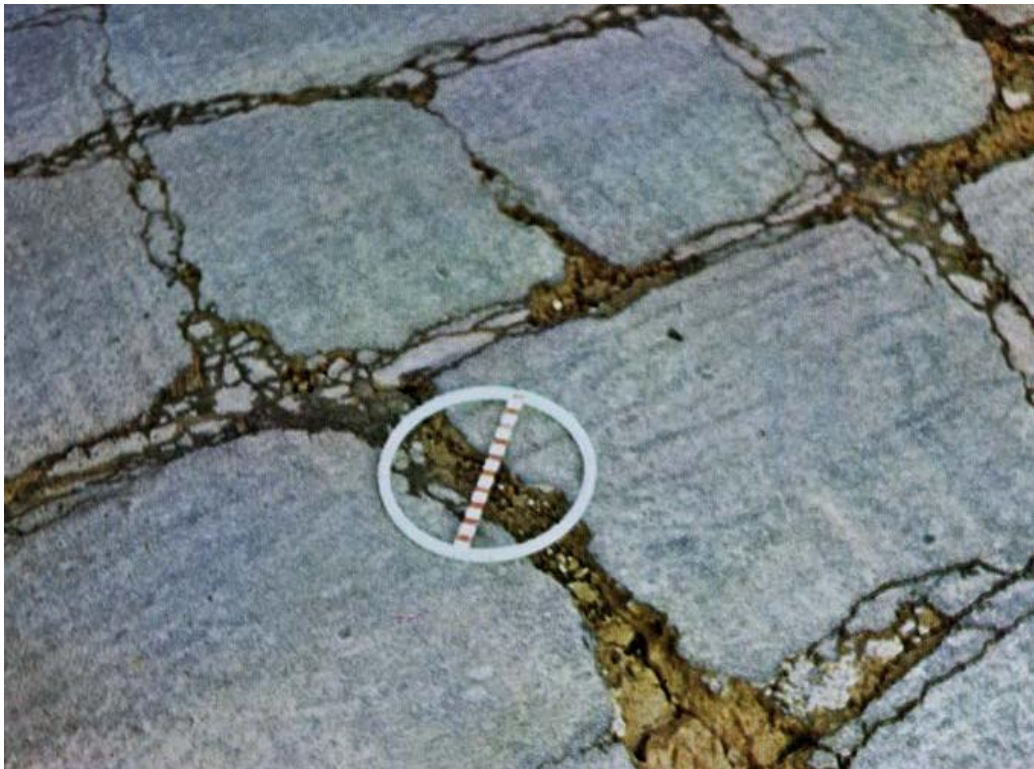
Figura 26: Trinca interligada do tipo bloco. Fonte: DNIT, 2003, p. 7
