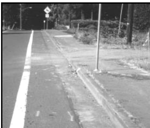
Figura 9.2: Terra arrastada pelo tráfego de veículos saindo de lote em construção
