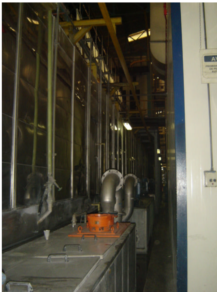
Figura 35: Foto parcial do túnel de pré-tratamento TRIAB. Fonte: Próprio autor, 2006. Cortesia BSH Continental Ltda.
