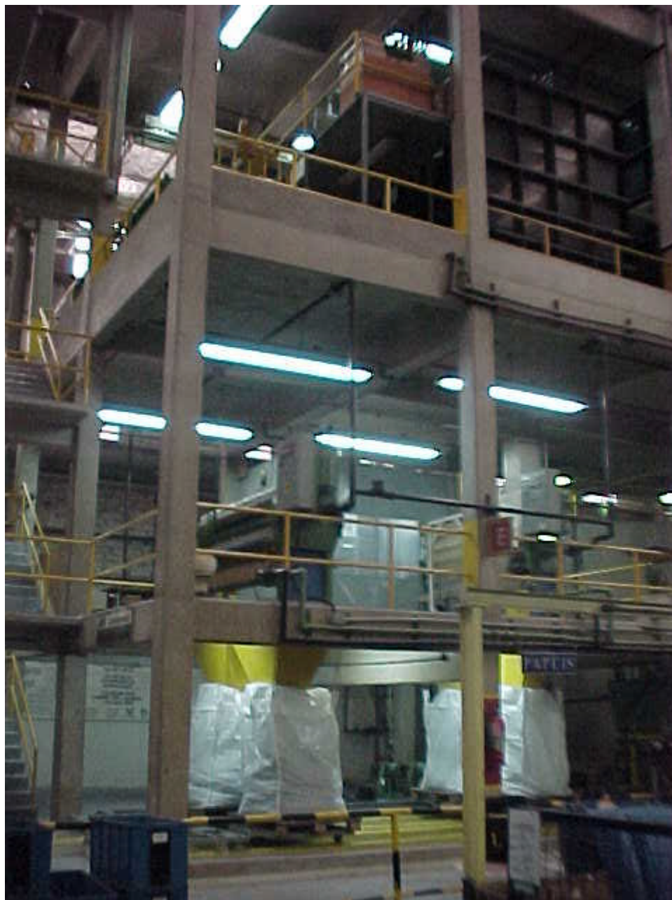
Figura 42: Foto da parte inferior da estação mostrando a disposição do resíduo sólido em sacos tipo big-bag . Fonte: Ribeiro, 2000. Cortesia BSH Continental Ltda.
