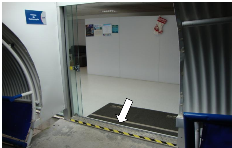
Fotografia 14: Entrada da clínica de fisioterapia com destaque para o degrau Fonte: A autora.
