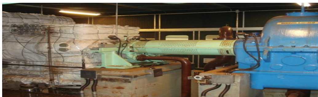
Figura 10. Equipamentos para constituição do segundo grupo gerador. Fonte: Arquivo da própria Usina.
