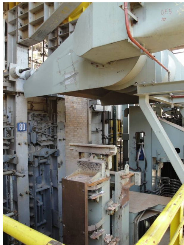
Figura 5-5: Coifa do sistema de controle de vazamentos da máquina desenformadora. USIMINAS (2010). Acervo do autor
