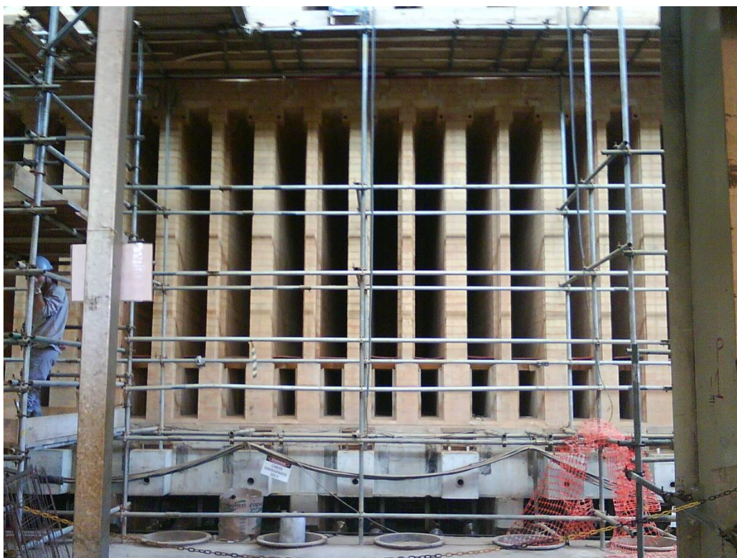
Figura 5-13: Usiminas. Coqueria 03 (2009). Regeneradores Acervo do autor.
