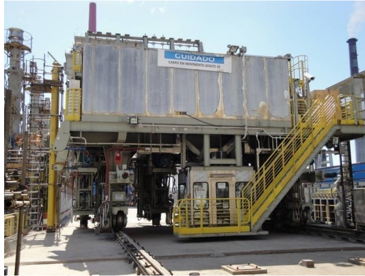
Figura5-14: Usiminas. Coqueria 03 (2010). Carro de carregamento selado Acervo do autor.
