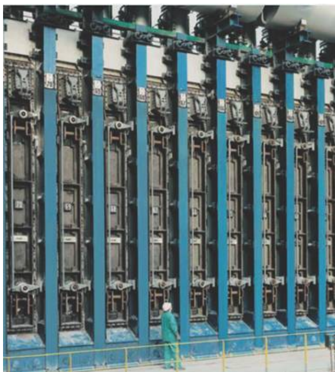
Figura 4-10: Portas de fornos de coque (UHDE GMBH THYSSENKRUPP, 2009a).
