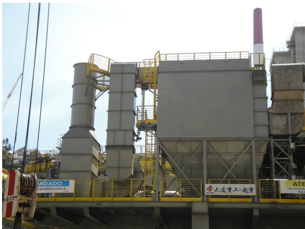
Figura 5-6: Exaustor e filtro do sistema de controle de vazamentos da máquina desenformadora. USIMINAS (2010). Acervo do autor
