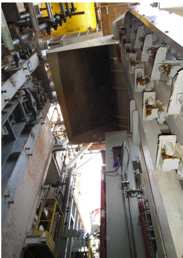
Figura 5-4: Coifa do sistema de controle de vazamentos da máquina desenformadora. USIMINAS (2010). Acervo do autor
