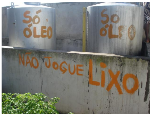
Figura 12. Tanques reservatórios – despejo indevido de lixo
