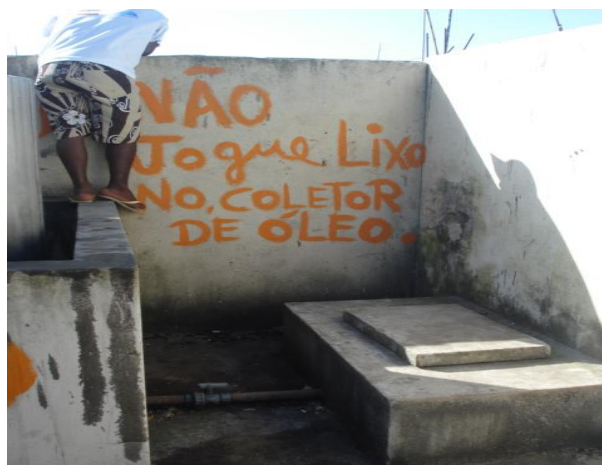
Figura 13. Tanques reservatórios – despejo indevido de lixo
