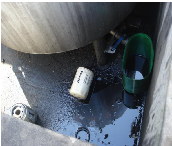
Figura 14. Tanques reservatórios – despejo do óleo em local inadequado – área de contenção
