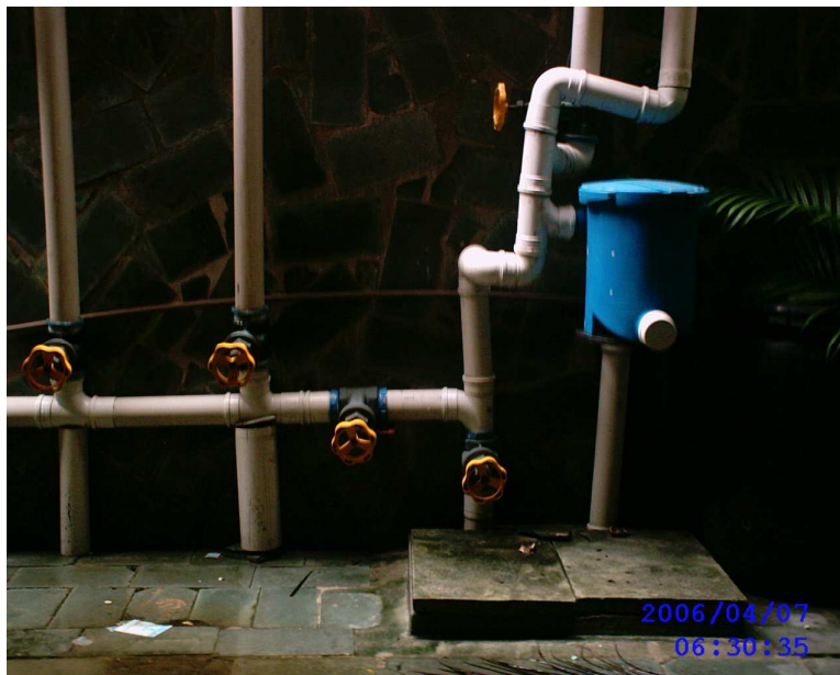
Figura 7. 10 - Sistema de captação e remoção de partículas sólidas das águas pluviais.
