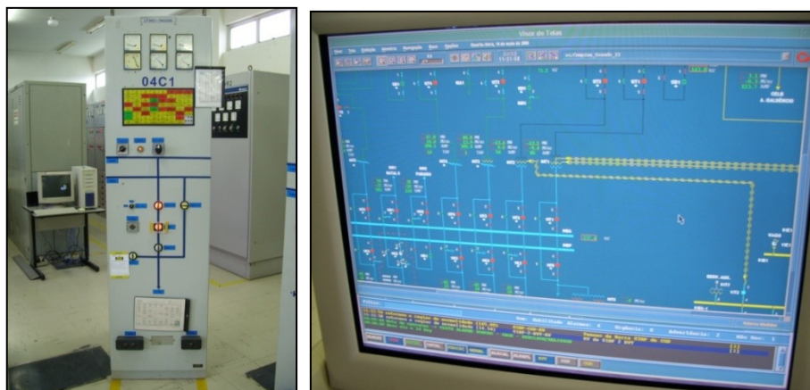
Figura 3-5 – Painel de comando e tela do supervisório (Fonte: Subestação CHESF, Campina grande)
