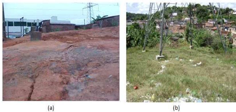
Figura 4.15 Erosão estrutura T3A - a) antes do plantio de vegetação e b) após o plantio.
