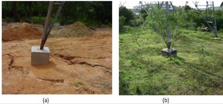
Figura 4.14 Erosão estrutura T1A - a) antes do plantio de vegetação e b) após o plantio.
