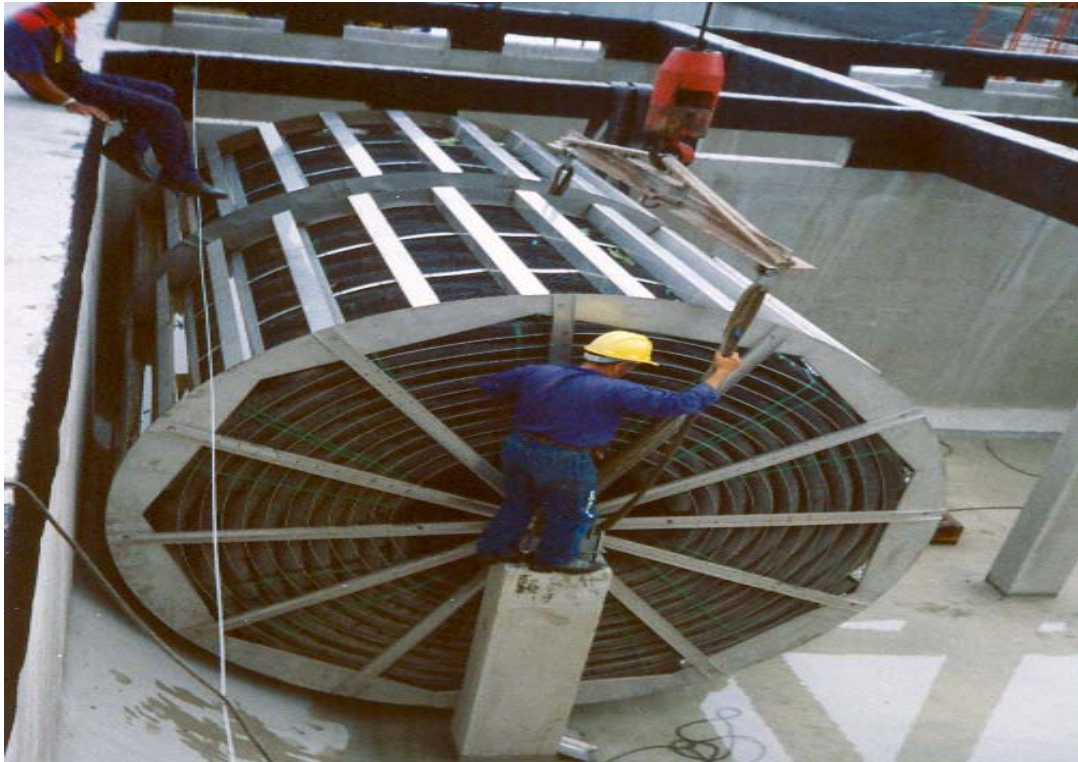
Figura 16. Foto do biodisco utilizado, em instalação no tanque de aeração.
