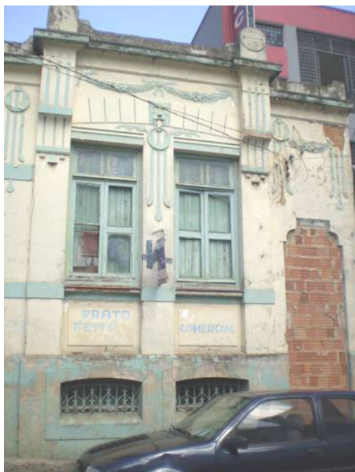
Figura 45 – Edificação abandonada Rua Cônego Cipião, nº438 Arquivo pessoal – 17 de setembro de 2008.
