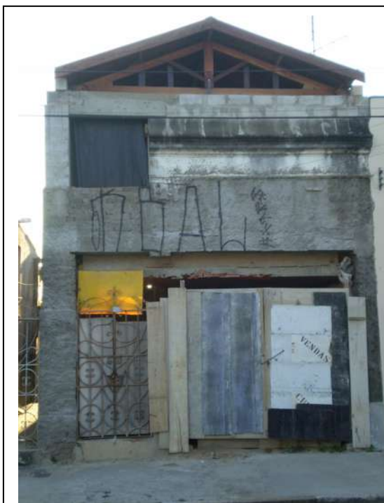
Figura 42 – Edificação inacabada invadida Rua Barão de Parnaíba, entre Ruas Benjamin Constant e Barreto Leme Arquivo pessoal – 24 de setembro de 2008.
