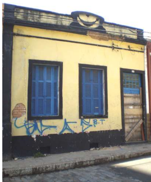
Figura 46 – Edificação abandonada Rua Álvares Machado, nº 338 Arquivo pessoal – 17 de setembro de 2008.
