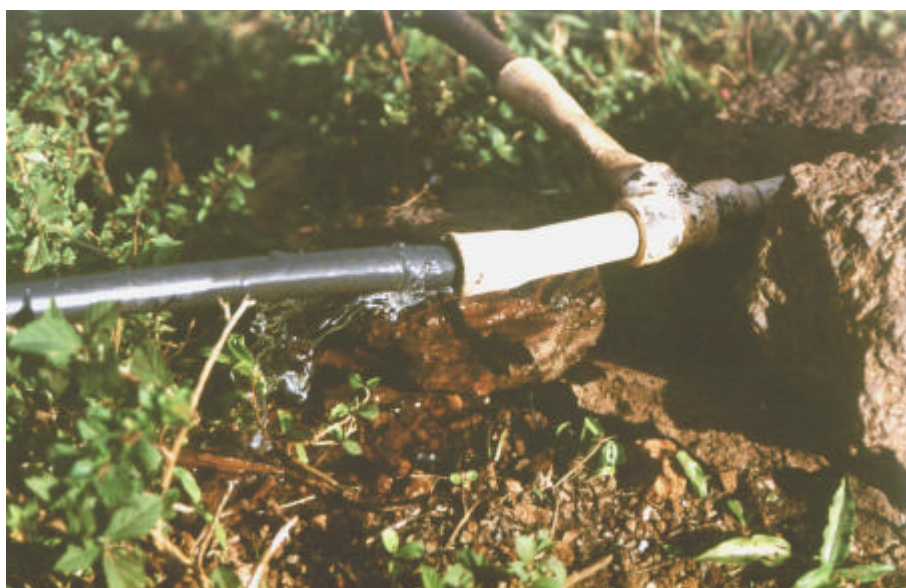
Foto 3.7: Vazamento em uma das mangueiras que leva água até as residências
