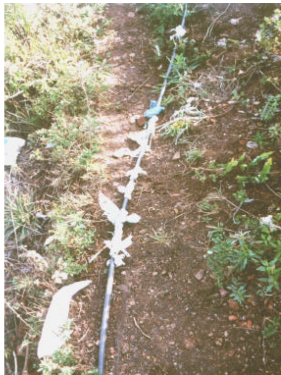
Foto 3.6: Mangueira que leva água até as residências, em péssimo estado de conservação.
