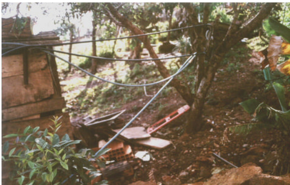
Foto 3.11: Emaranhado de mangueiras que levam água para o reservatório.
