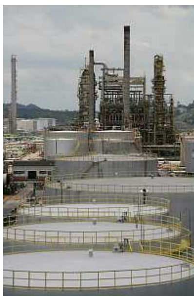
Figura 6. Tanques de armazenamento
