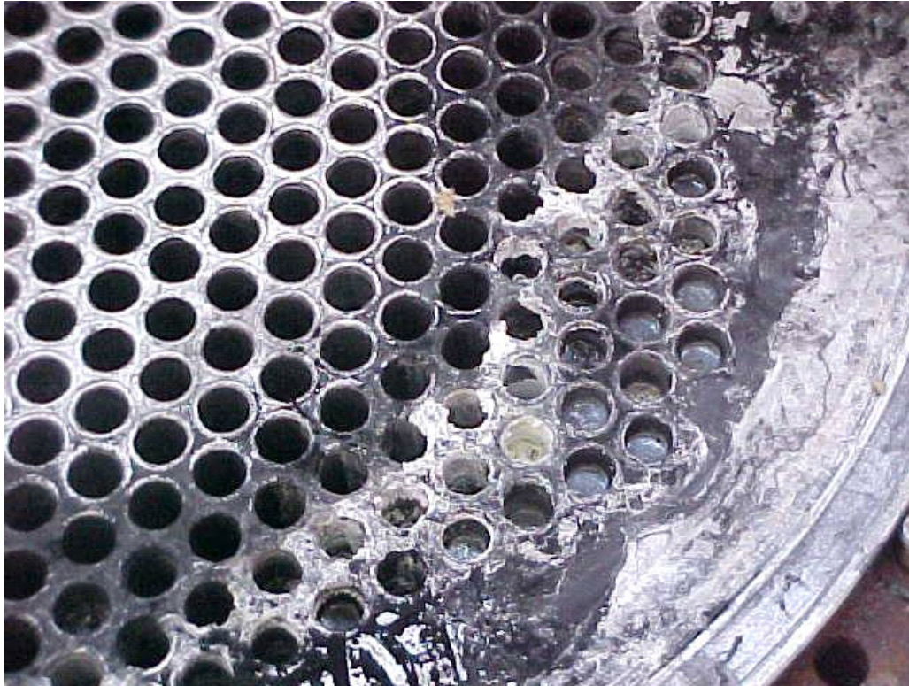
Figura 13- Detalhe da incrustação nos tubos do trocador de calor (Agosto/05)
