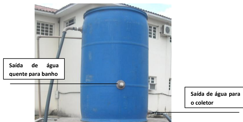
Figura 3.13. Detalhe dos furos no reservatório, vistos frontalmente.
