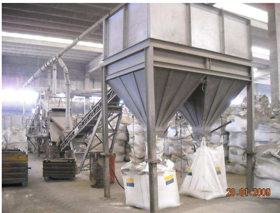
Figura 8A - Silos para armazenagem da escória moída e ensaque em big-bags
