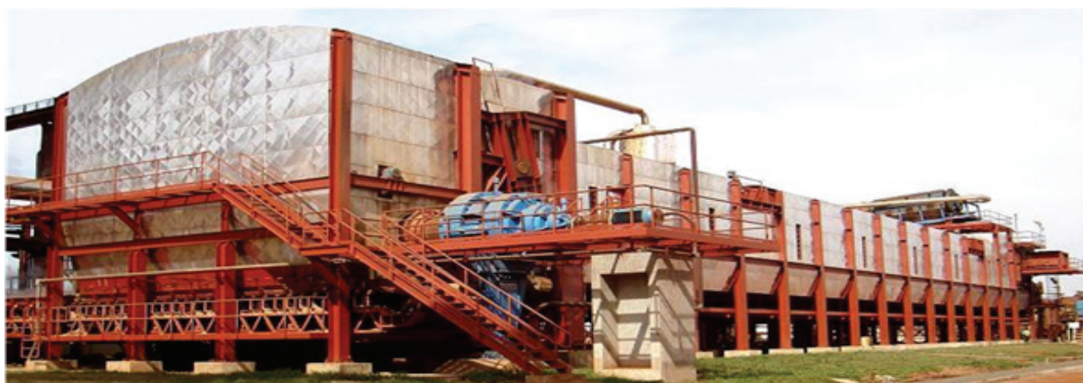
Figura 2.15: Difusor da Usina São João de Araras II com capacidade de 12.000 t de cana por dia. (Fonte: UNI-SYSTEMS).
