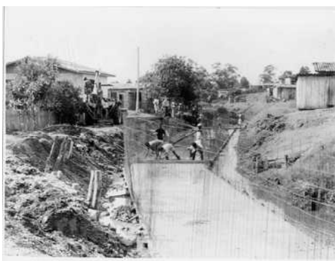
Figura 4.04: Vista do processo inicial de canalização do rio Criciúma em um dos bairros
