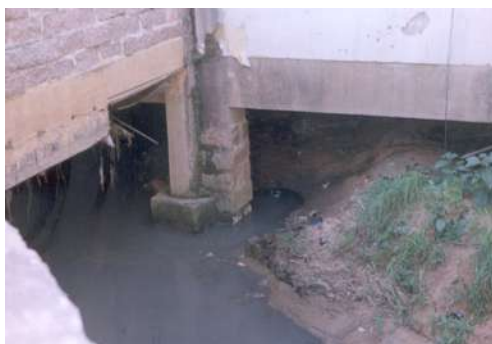
Figura 4.26: Vista parcial de um prédio construído com um dos seus pilares posicionados no leito do rio Criciúma, localizado na rua Marcos Rovaris, no Centro
