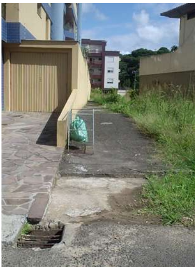
Figura 4.19: Vista parcial de parte do afluente formador do rio Criciúma (margem direita), com contenção de margem, de fundo e com recobrimento superior, na rua Lauro Muller. Acervo: Rose Maria Adami, 2004.
