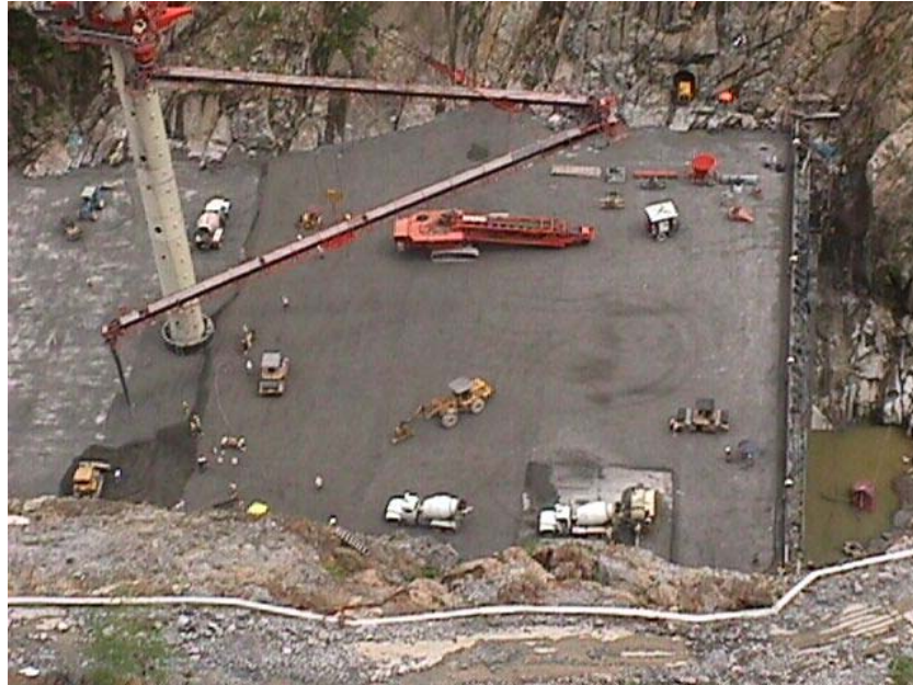
FIGURA 2.30 Detalhe da Praça de CCR de Miel I Fonte: Acervo pessoal do Eng. Francisco Rodrigues Andriolo
