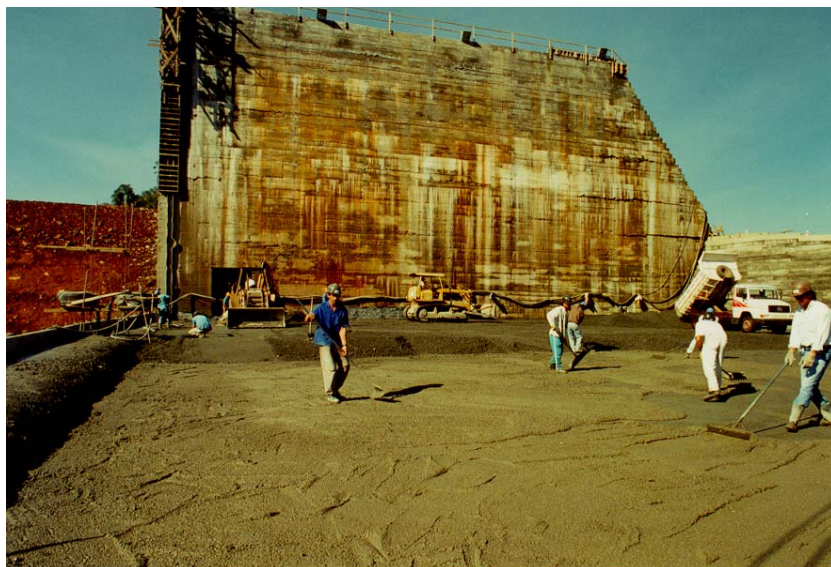
FIGURA 2.29 Detalhe de Espalhamento de Argamassa, Face de Montante e Juntas de Contração
