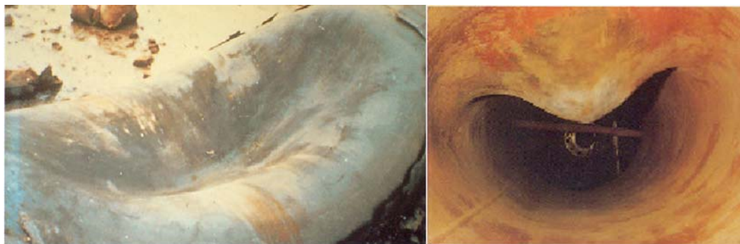
Figura 1: Moessas em dutos (a) vista externa (b) vista interna [Macaw's pipelines defects].
