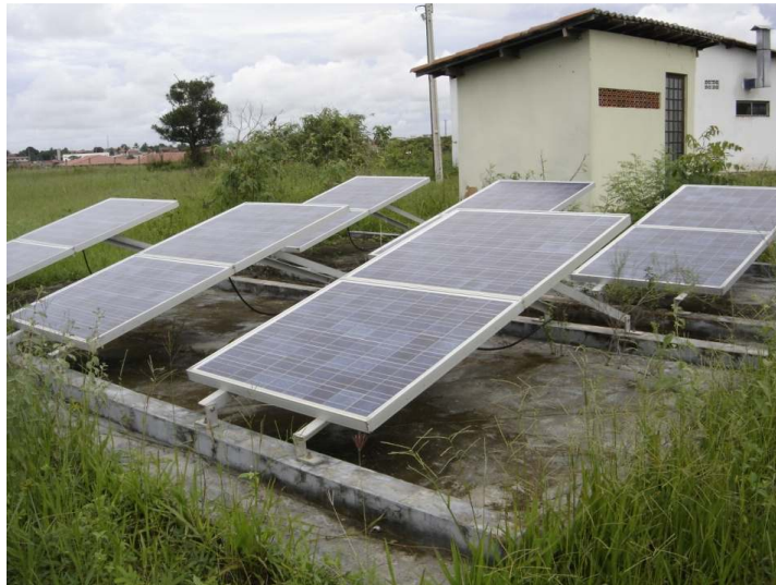
Figura 19 - Conjunto de painéis fotovoltaicos instalados nas dependências do MCFA/UECE, Campus do Itaperi.
