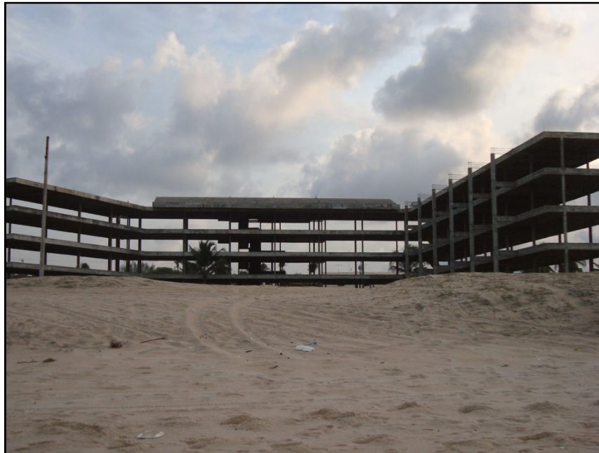
FIGURA 40 - Construção com quatro pavimentos – embargada e abandonada. Vista da praia. Fonte: Lúcia Sabóia, Jan./ 2010
