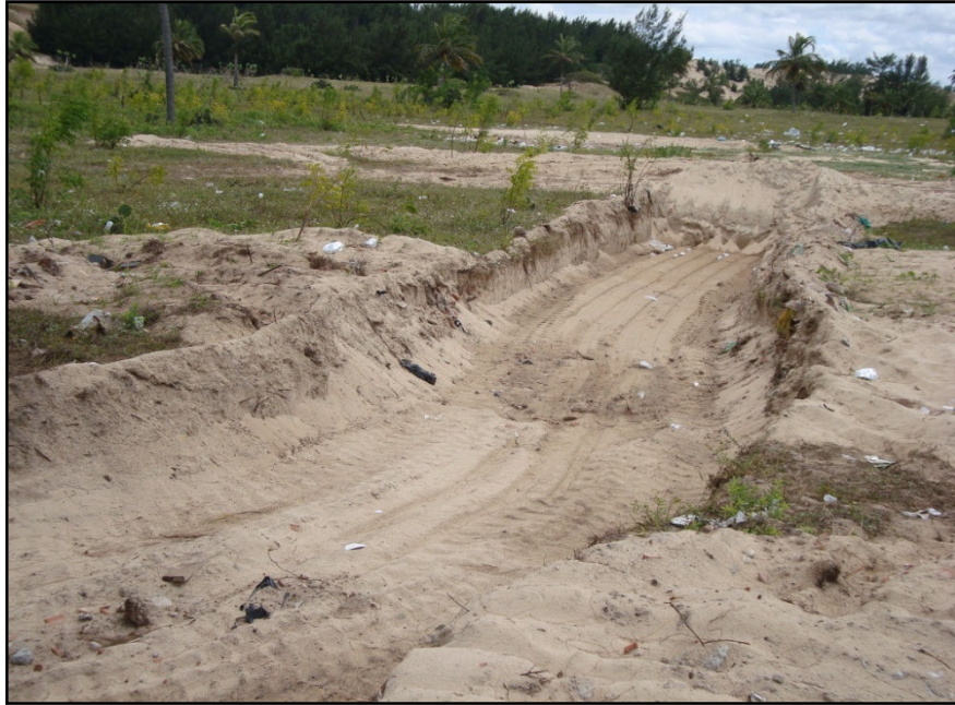
FIGURA 44 - Retirada de material de empréstimo para a construção do Vila Galé Cumbuco Golf Resort.
