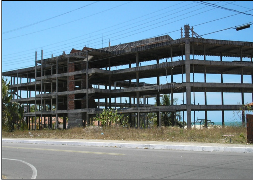
FIGURA 39 - Construção com quatro pavimentos – embargada e abandonada. Vista da avenida. Fonte: Lúcia Sabóia, Set./ 2007
