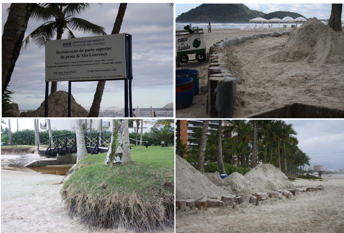
Figura 33 – Obras de proteção para conter ou minimizar o impacto do fluxo das águas. Fotos: Ana Paula Alípio, 2009.
