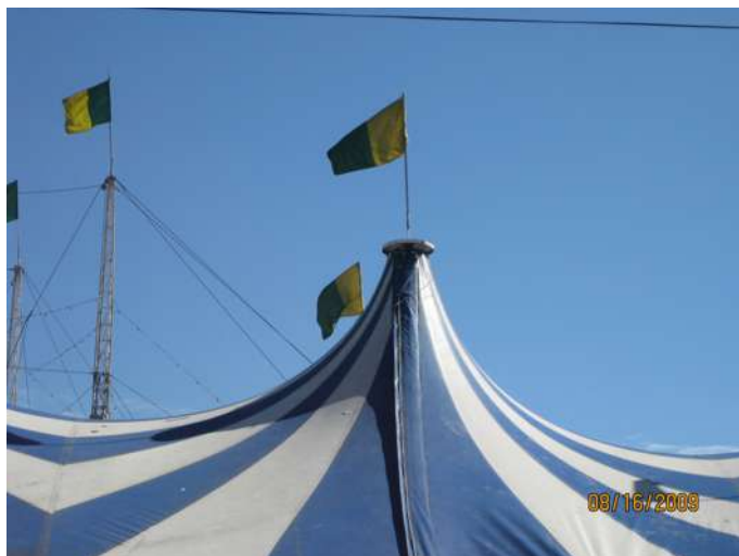
Figura 6.47 Vista lateral com enrugamento e emenda de membranas (da autora, 2009)
