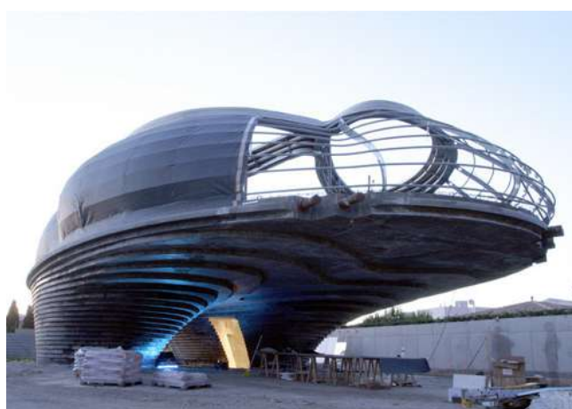
Figura 5.13 Vista da obra do Vila Nurbs, tendo com vista os tubos estruturais de fechamento da obra, disponível em http://www.villanurbs.com/ (acesso em 06/07/2009).
