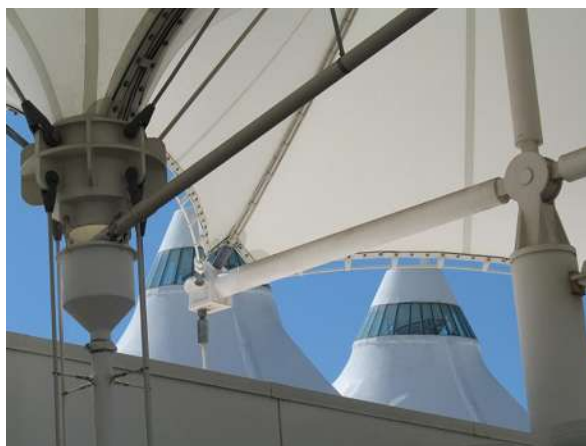
Figura 5.200 Detalhe de terminações de cabos no Aeroporto de Denver, disponível em http://en.structurae.de/photos/index.cfm?JS=109918 (Sigrid Kramarczik) em 16/07/2009.
