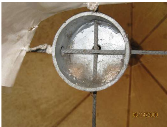
Figura 6.26 Vista inferior do mastro com cabos passantes (da autora, 2009).
