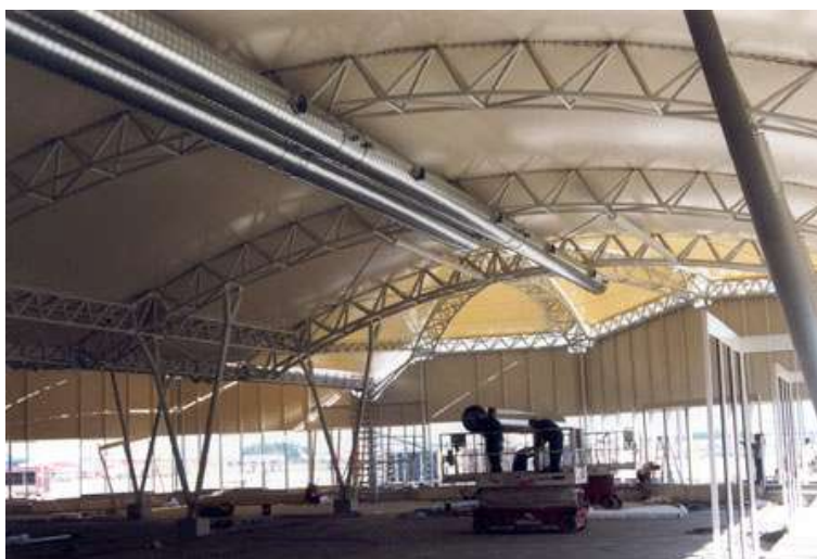
Figura 5.154 Vista interna em fase de montagem do galpão de aeroporto em Zaventem, Brussel – Bélgica, disponível em http://www.tensinet.com/database/viewProject/3996.html em 17/07/2009.
