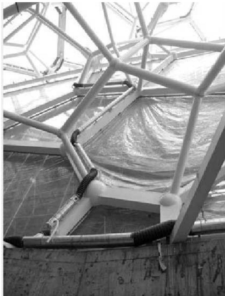
Figura 5.57 Tubulação para inflar colchões e contato da estrutura metálica com a de concreto (disponível em http://www.natgeo.com.br/especiais/estadionacionaldepequim/gallery.asp 04/08/2008)
