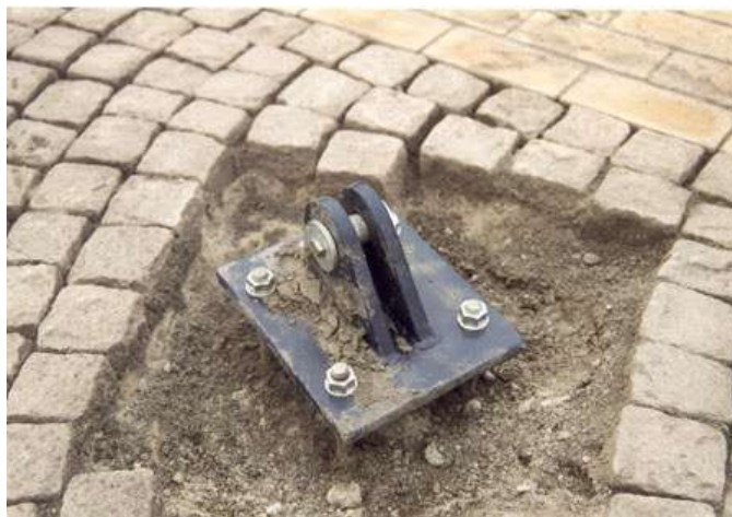
Figura 5.213 Ancoragem nivelada para reposição dos acabamentos em pedras de Espaço Público de uso temporário na Bélgica, disponível em http://www.tensinet.com/database/viewProject/3995.html 17/07/2009
