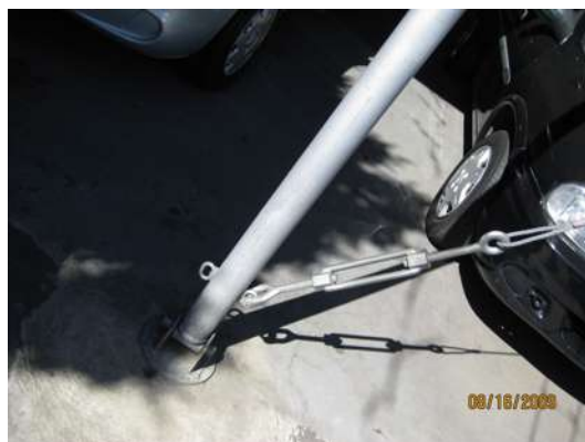
Figura 6.62 Vista de fixação de cabo de contraventamento em mastro lateral com esticadores e olhas rosqueáveis (da autora, 2009).
