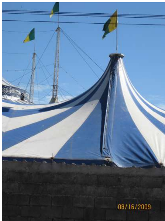
Figura 6.50 Vista da emenda entre membrana (da autora, 2009)
