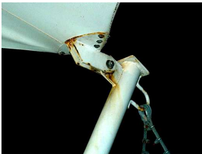
Figura 6.11 Conexão de mastro de borda e mastro com cabos, ambos com fortes indicativos de corrosão e início de perda da seção da chapa sanduíche de fixação da membrana (da autora, 2007)
