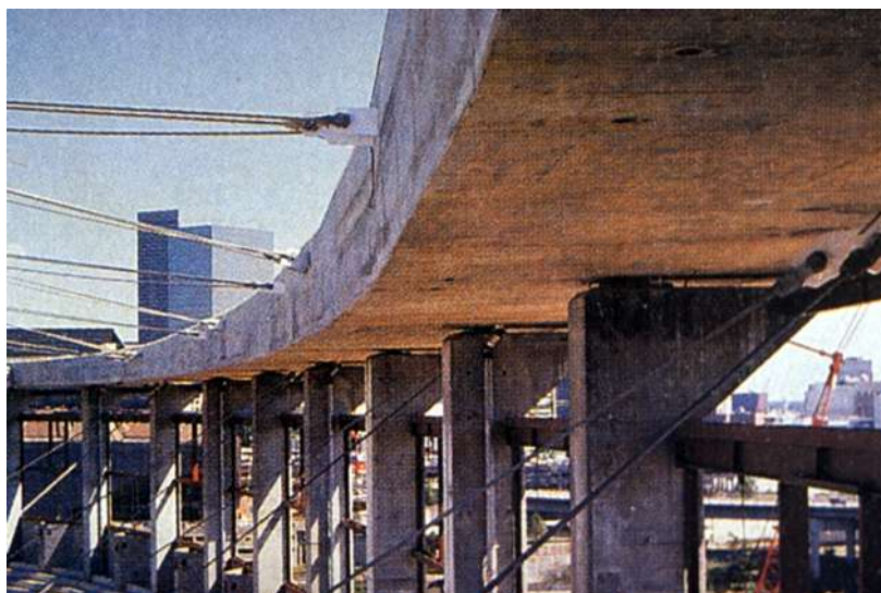
Figura 5.105 Estrutura de cabos ancorados em anel perimetral de concreto do Georgia Dome (Disponível em http://www.columbia.edu/cu/gsap/BT/DOMES/GEORGIA/ em 08/08/2001).
