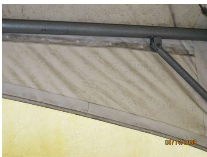
Figura 6.29 Vista da sai com enrugamentos diagonais (da autora, 2009).
