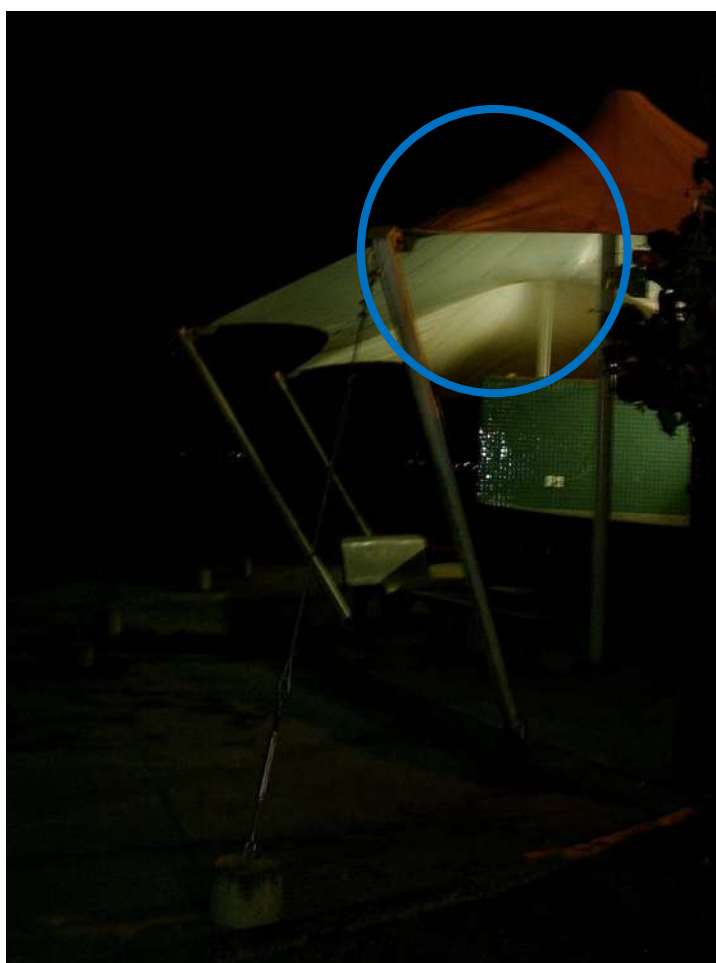
Figura 6.7 Enrugamento de membrana no encontro do topo do mastro de borda lateral esquerda (da autora, 2007)
