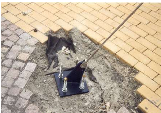
Figura 5.211 Ancoragem com cabo com conector durante etapa construtiva de Espaço Público de uso temporário na Bélgica, disponível em http://www.tensinet.com/database/viewProject/3995.html 17/07/2009
