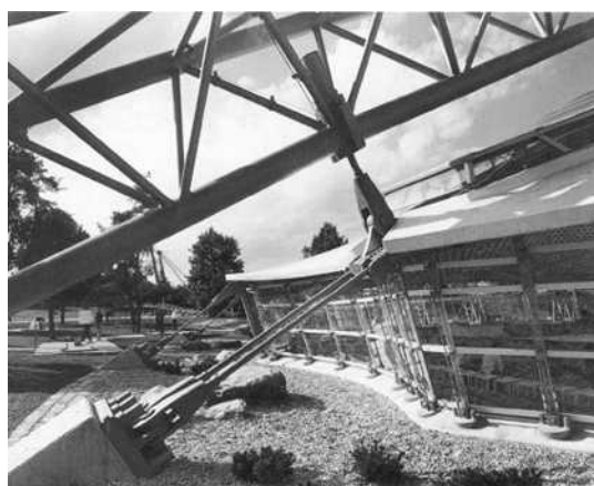
Figura 5.218 Bloco de ancoragem dos cabos estruturais com apoio articulado, disponível em http://www.tensinet.com/database/viewProject/3834.html em 17/07/2009.
