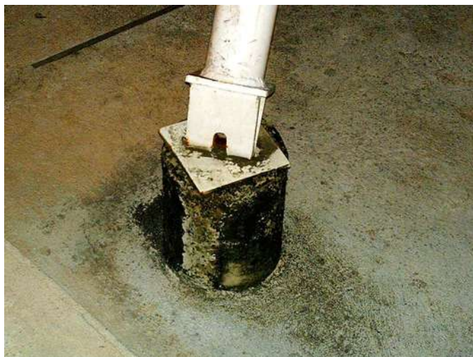
Figura 6.10 Conexão de mastro lateral e base rígida sobre o solo, notando-se já pontos de corrosão da peça de articulação metálica e degradação da base de concreto (da autora, 2007)
