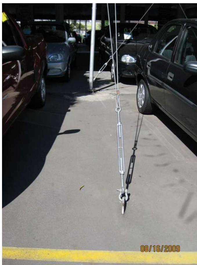
Figura 6.61 Vista da ancoragem no solo e utilização de esticadores com olhais rosqueáveis (da autora, 2009).
