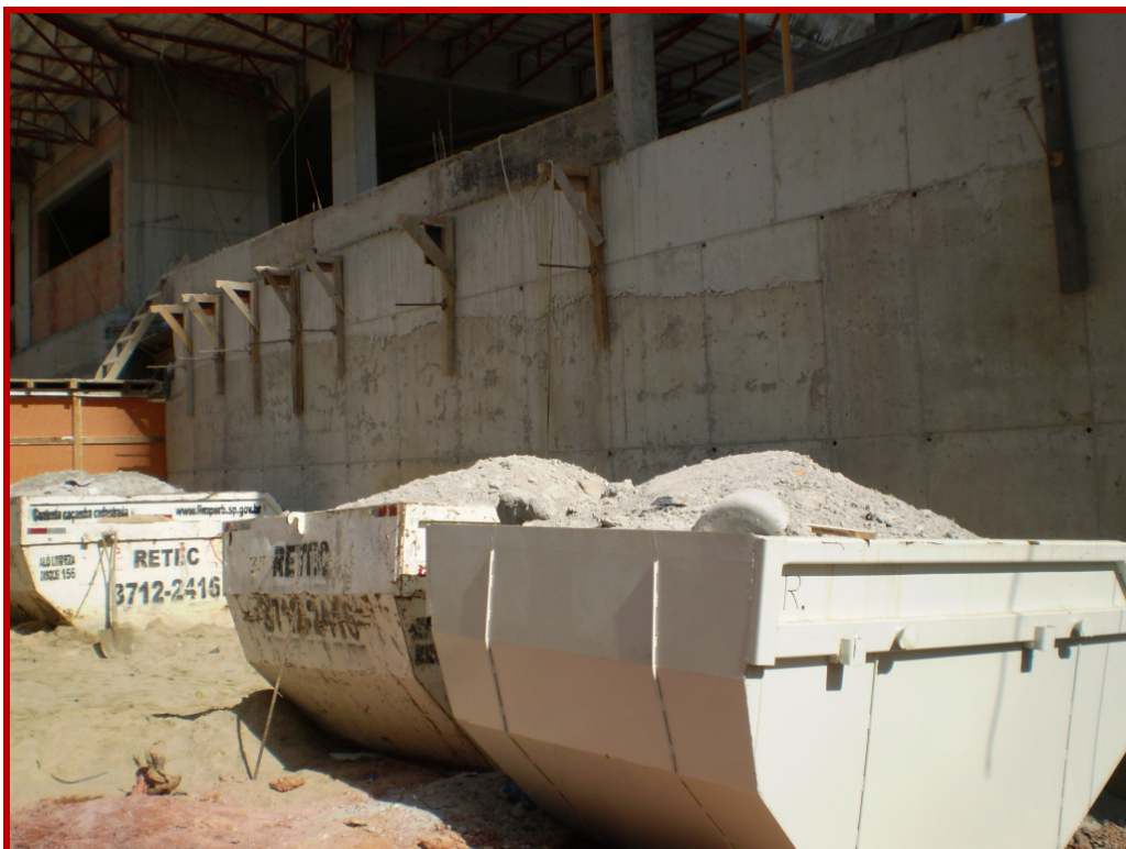
Figura 4.37 - Sobra de argamassa de fachada de uma obra de três torres residenciais na Região Metropolitana de São Paulo armazenada para reúso no piso da área externa
