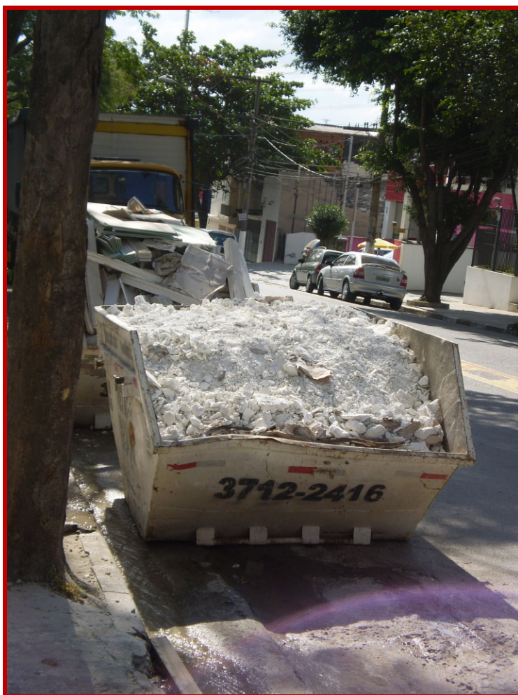
Figura 4.38 - Segregação do gesso em uma obra de construção de três torres residenciais na Região Metropolitana de São Paulo
