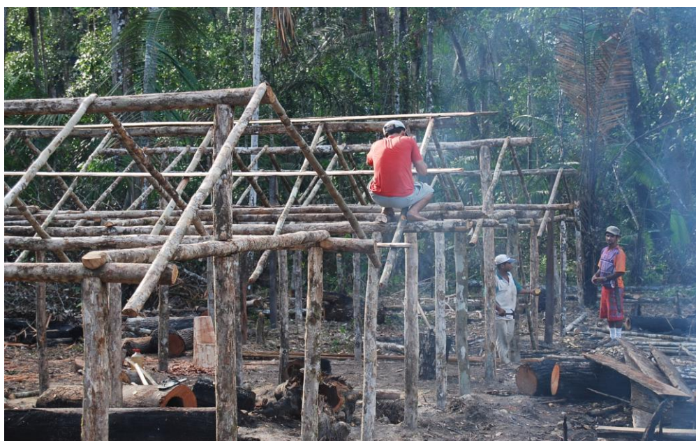
Figura 8: Instalação do núcleo inicial do acampamento Patoá. Fonte: Ednaldo Morais (2008). Acervo: CAR, CPT, MMC.
