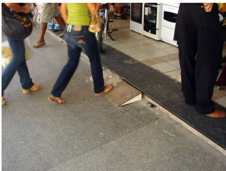
Figura 58 - Improvisação com rampa de madeira no centro de Maceió
