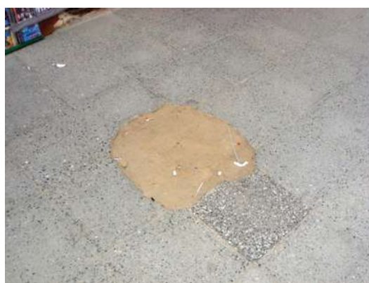
Figura 62 – Falta de manutenção
