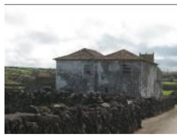
Figura 234: sobrado em ruínas, Caldeira. Fonte: fotografia da autora, 02/03/2008
