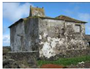
Figura 235: sobrado em ruínas, Caldeira. Fonte: fotografia da autora, 02/03/2008
