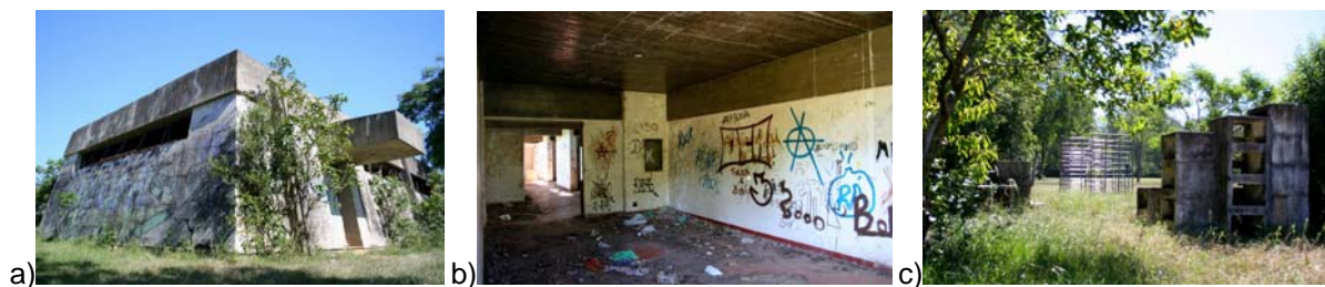
Figura 4.31 – Edificações e equipamentos abandonados pelo Parque do Trabalhador: a) Fachada deteriorada do antigo vestiário; b) Lixo e vandalismo dentro do antigo vestiário; c) Playground abandonado. Fonte: Roberto Coutinho, 2008.
