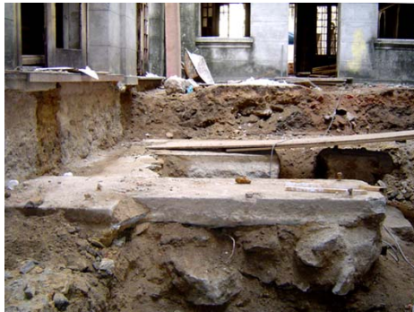
Imagem 257 – Bases de pedra talhadas - forma de grandes paralelepípedos - com pinos de ferro.
