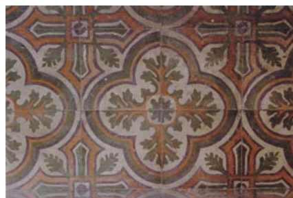
Imagem 270 – Piso em ladrilho hidráulico da louçaria.
