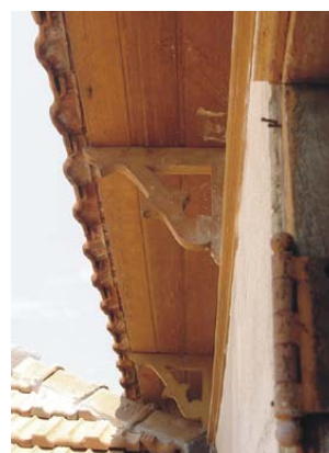
Imagem 82 – Telhado da caixa de elevador do edifício principal do Hotel Sete de Setembro – beiral forrado com tabuado de madeira, dotado de falsas mãos francesas.
