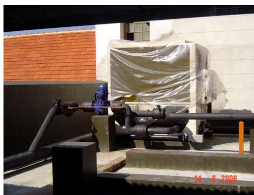
Imagem 332 – Ar-condicionado – laje no prédio Principal.
