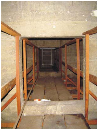
Imagem 163 - Passarela para manutenção interna do telhado 02.
