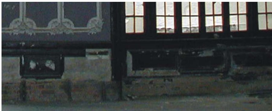
Imagem 53 – Lambri de estuque do salão principal – localizado no térreo do salão principal do Edifício anexo do Hotel Sete de Setembro, durante as obras de restauração.
