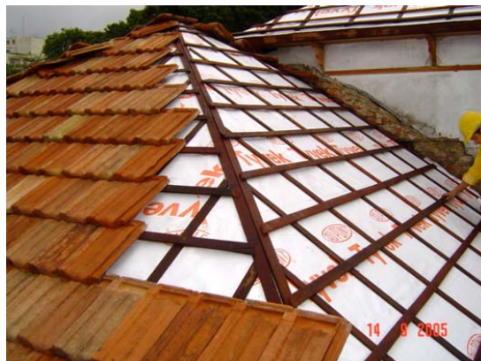
Imagem 333 – Montagem do telhado – detalhe do encaixe das telhas, da manta e do madeiramento.
