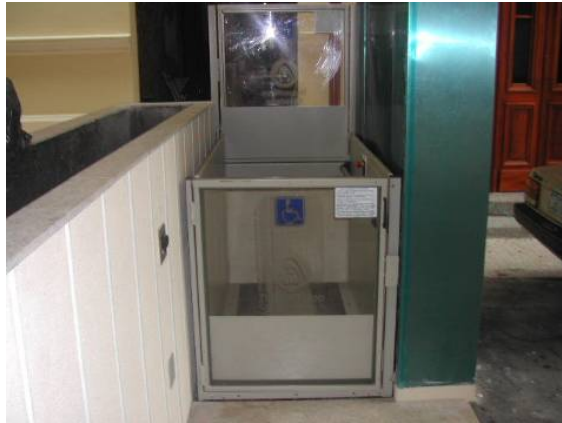
Imagem 324 – Plataforma elevatória para deficientes.
