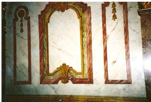
Imagem 48 – Teatro Municipal - parede com pintura fingindo mármore e granito.
