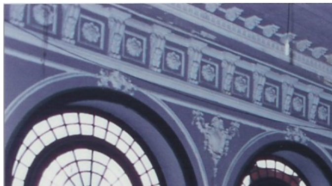
Imagem 57 – Detalhes dos elementos decorativos junto ao forro do salão principal do térreo do Edifício anexo do Hotel Sete de Setembro – antes da restauração.
