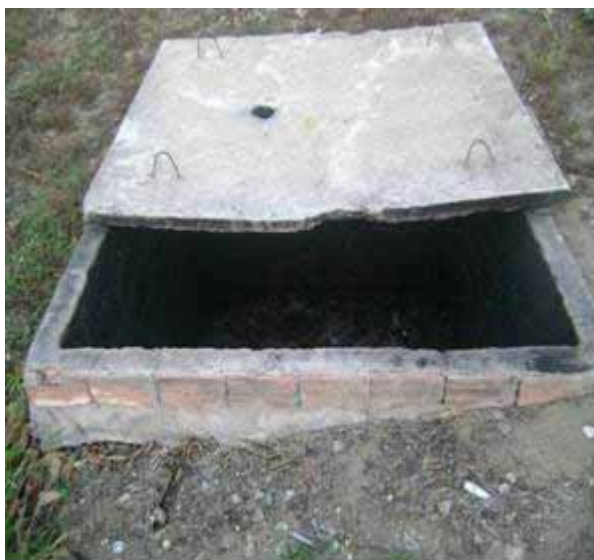
Figura 28 - Tanque (queimador) construído para receber RSS de Ibateguara.
