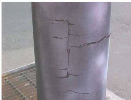
Figura 5.8: tubo central destruído por trincas de SCC (CENIBRA, 2003).
