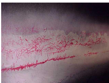
Figura 5.5: trincas de SCC na região de transição do digestor 1 (CENIBRA, 2003).
