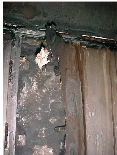
Figura 5.4: corrosão de chapa cega (CENIBRA, 2002).
