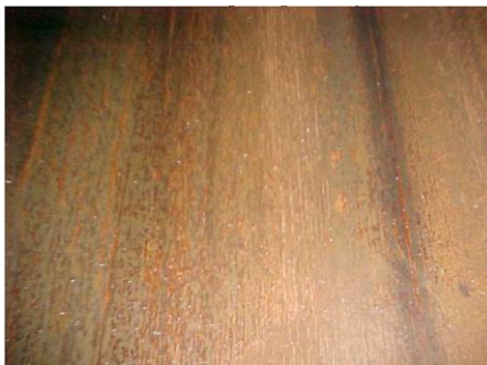
Figura 3.9: superfícies ativas, corrosão uniforme (CENIBRA, 2002).
