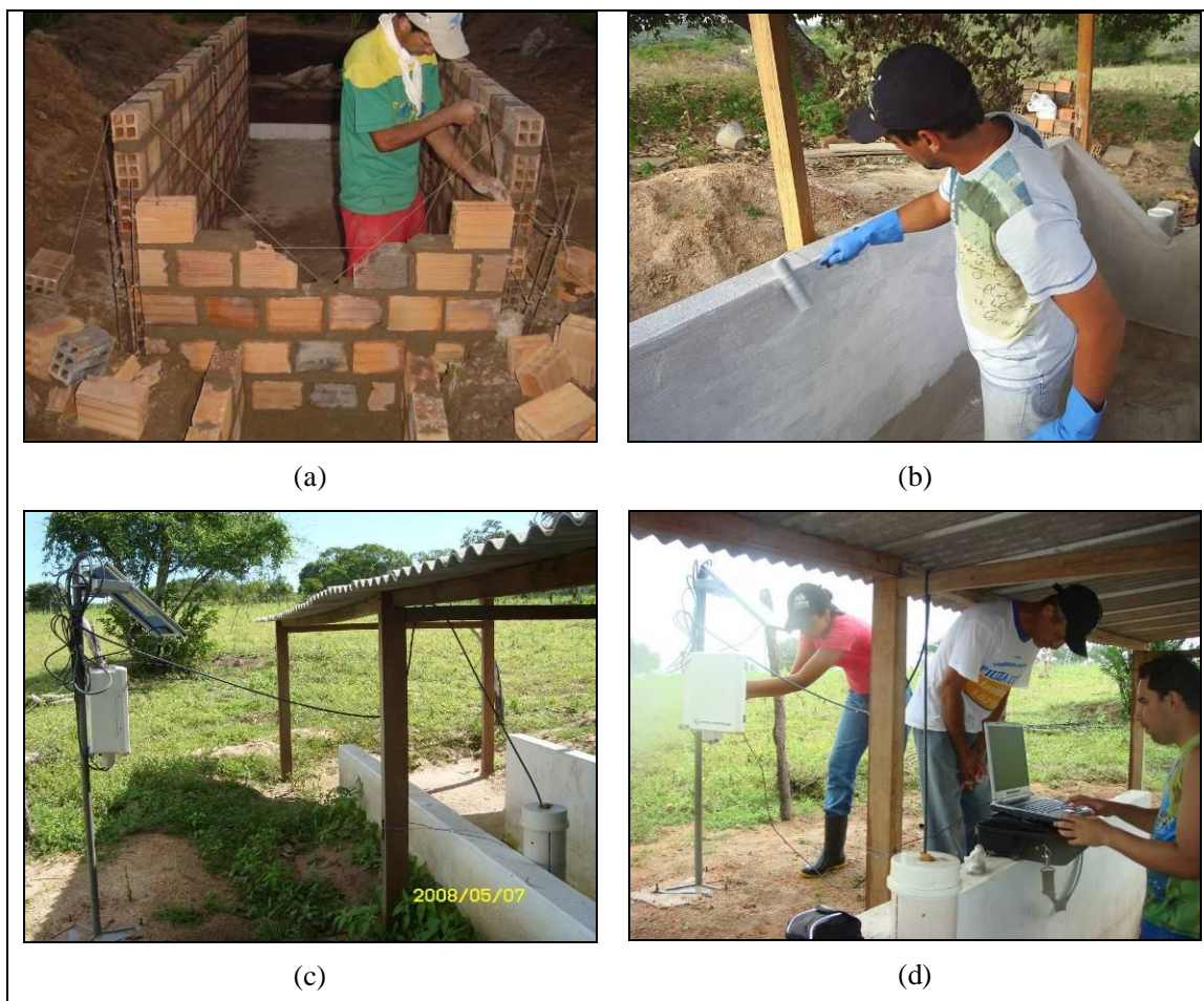
Figura 17 – Etapas da construção, instrumentação e coleta de dados na fossa de sedimentos: (a) Construção do vertedor; (b) Pintura das paredes; (c) Configuração utilizada na instalação do linígrafo; e (d) Coleta de dados do linígrafo.
