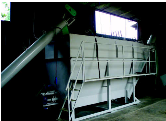
Figura 29 - Tanque de separação
