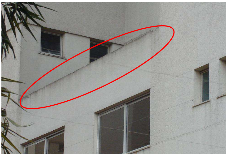
Figura 5.77 - Manchas em elemento da fachada
