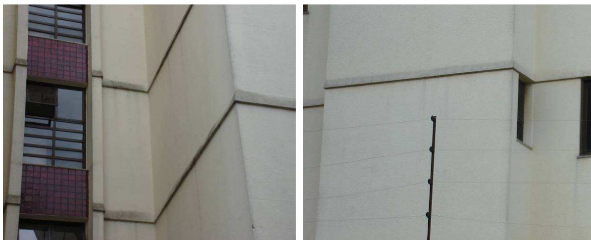
Figura 5.70 - Fachadas com orientação S com manchas formadas nas pingadeiras por acúmulo de sujeira
