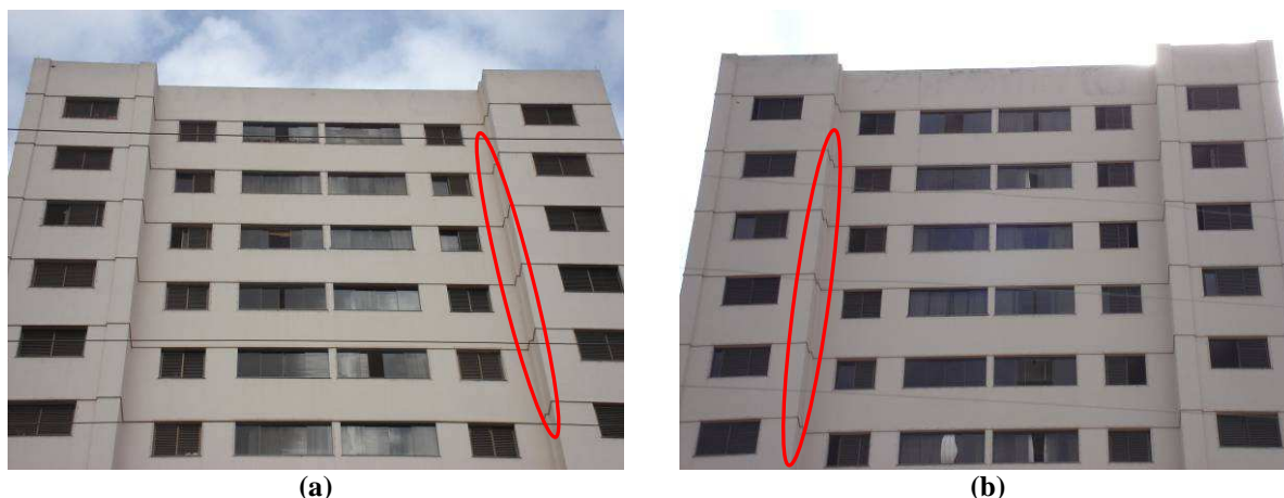
Figura 5.37 - Região da fachada onde ocorreu formação de manchas nas pingadeiras. Fachada E (a) e fachada O (b)
