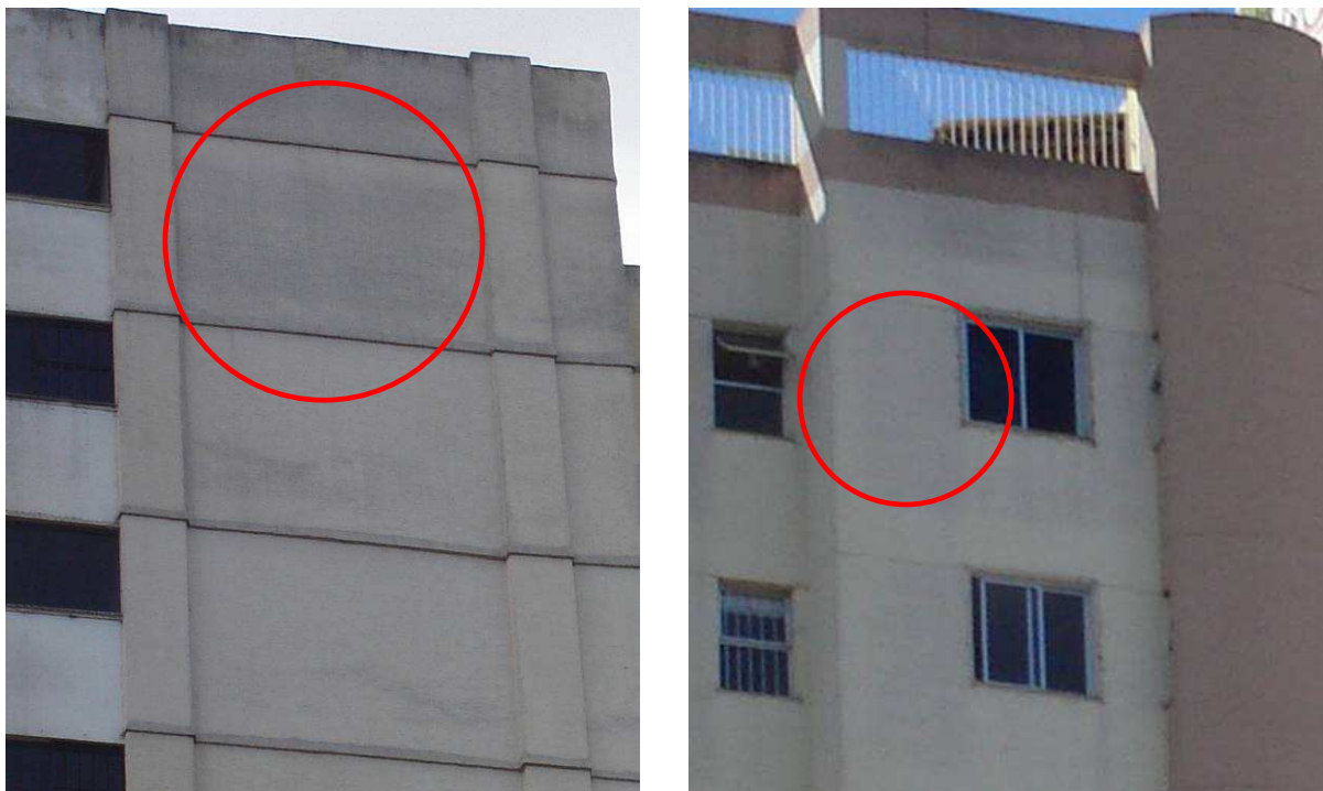
Figura 3.11 - Manchas nos elementos de vedação
