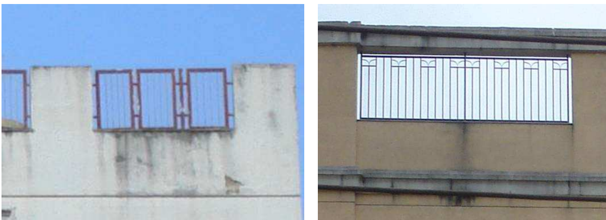
Figura 5.76 - Manchas de microorganismos em guarda-corpos de coberturas
