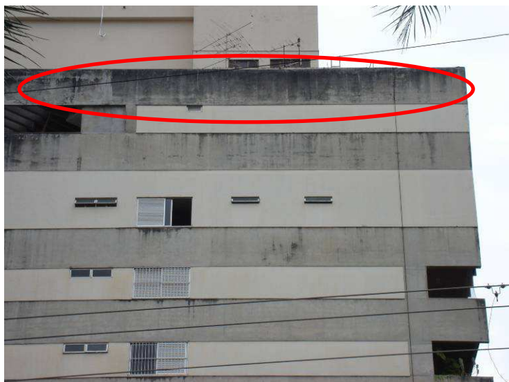
Figura 1.3 - Proliferação de microorganismos na platibanda de edifício na cidade de Goiânia
