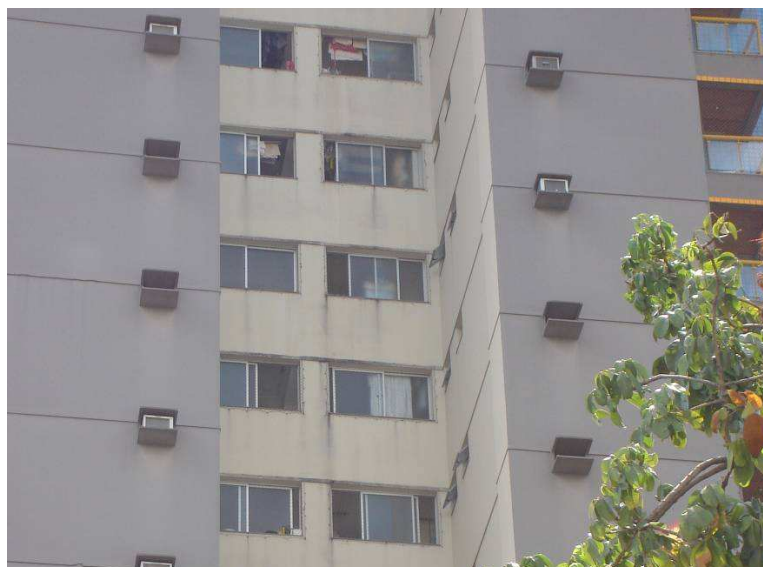
Figura 1.2 - Manchas de sujeidade próximas ao peitoril de janelas de edifícios na cidade de Goiânia
