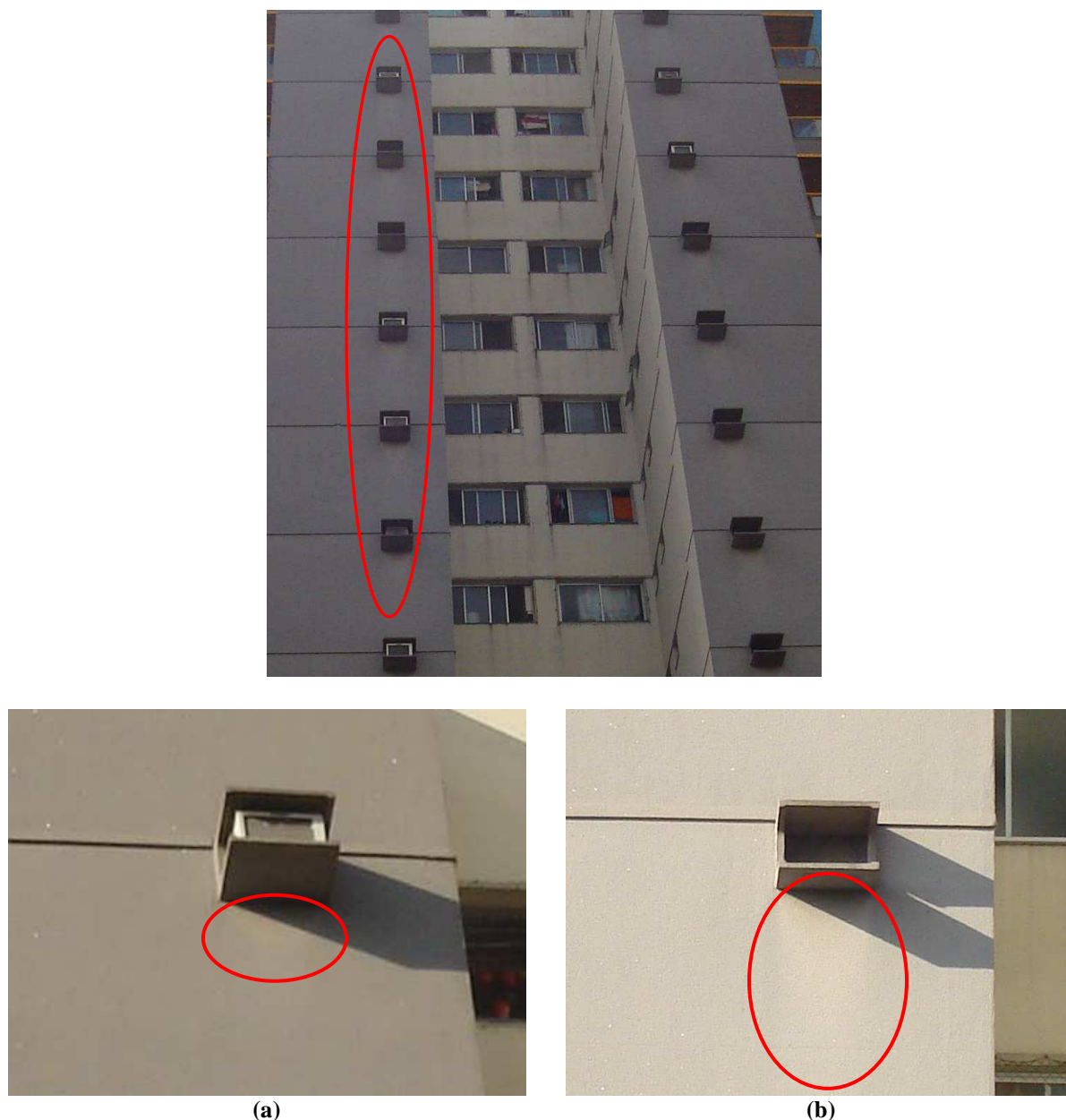
Figura 5.65 - Manchas formadas sob as caixas de ar condicionado no Edifício 5, 14º pavimento (a) e 2º pavimento (b)
