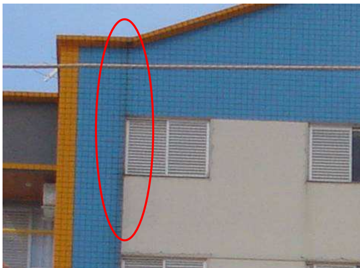
Figura 5.64 - Mancha formada por escoamento de água em platibanda de fachada do Edifício 5
