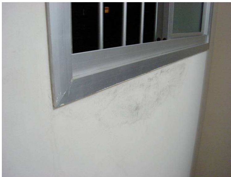
Figura 2.3 - Mancha interna devido à penetração de água através da esquadria presente na fachada
