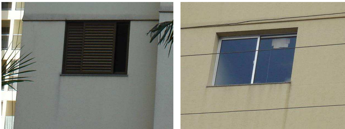
Figura 5.73 - Manchas nas fachadas ocasionadas por peitoris
