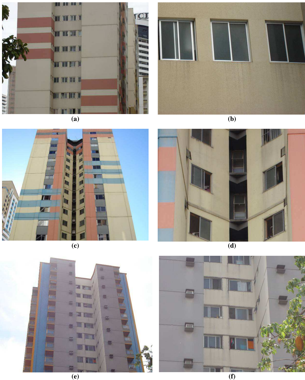
Figura 5.74 - Vista geral da fachada do edifício (a) e as manchas próximas à janela (b). Vista geral da fachada do edifício (c) e as manchas próximas à janela (d)
