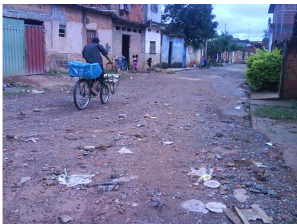
FIGURA 18 - Rua 08, a pavimentação necessita de restauração
