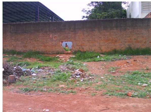
FIGURA 6 - Passagem improvisada na parede lateral da Escola Estadual Antônio Canela que dá acesso à quadra
