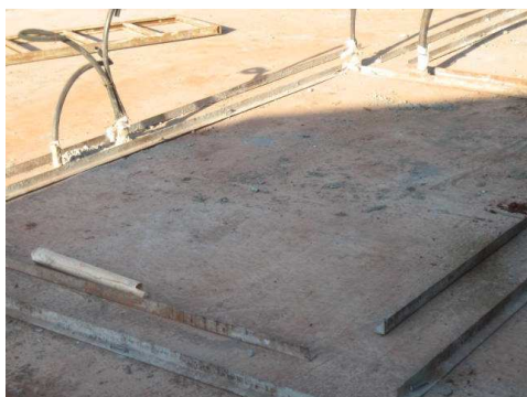
Figura 50. Fundação em radier: detalhe do ferro-guia para sustentação das fôrmas Fonte: BEZERRA, 2008.
