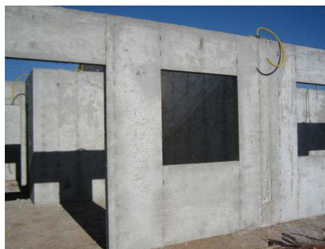
Figura 31. Vedações finalizadas prontas para receber esquadrias e acabamentos – São José do Rio Preto – SP. Fonte: BEZERRA, 2008.
