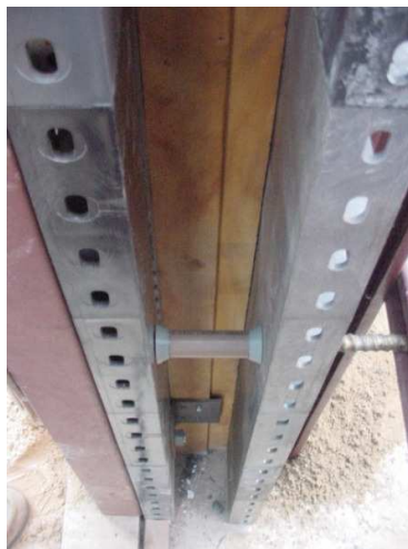
Figura 24. Detalhe da colocação do painel com espaçadores. Mont Mor – SP. Fonte: ROSSIGNOLO, 2005.
