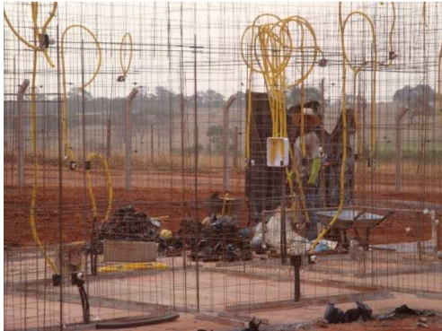
Figura 18. Detalhe instalações elétricas Fonte: BEZERRA, 2008.
