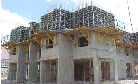
Figura 12. INPAR – Sistema de fôrmas na execução de edifício multipavimentos, escoramento e posicionamento das fôrmas. Fonte: SACT, 2008.
