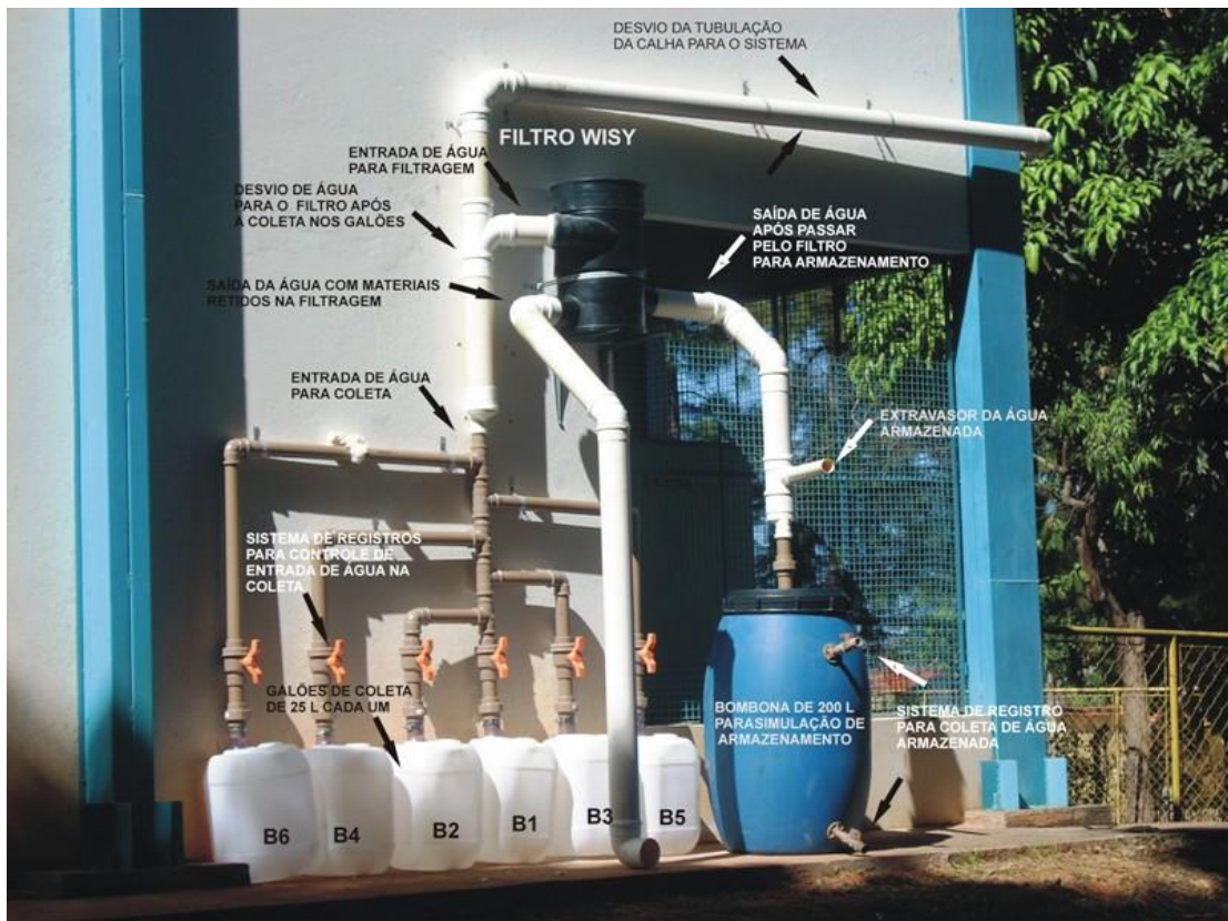
Figura 45 – Vista do sistema instalado para captação da água da CTB
