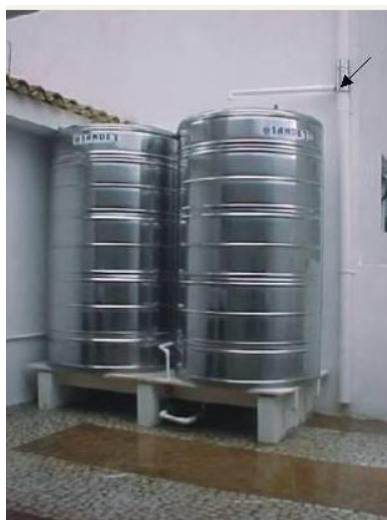
a - Reservatórios de aço inox com 3000 L cada
