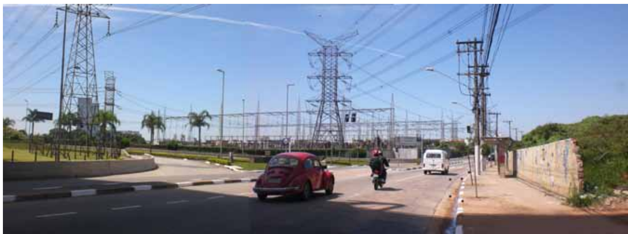
AV. GUIDO CALOI, PRÓXIMO AO METRÔ — SUBESTAÇÃO XAVANTES.
