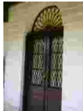
Fig. 333 – Detalhe da porta em arco pleno, com bandeira fixa em ferro. Fonte: CGLucas (2010)
