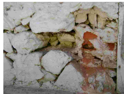
Fig. 261 – Detalhe do embasamento em pedra bruta seca da Estação de Antonio Rocha. Fonte: CGLucas, 2010.
