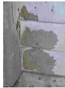
Fig. 315 – Detalhe da argamassa pulverulenta se desprendendo da alvenaria da estação de Engenheiro Passos (Boa Vista). Fonte: CGLucas (2010)
