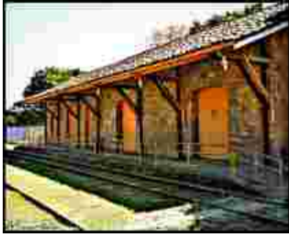
Fig. 239 – Fachada da Estação de Rocha Leão, com destaque para as portas. Fonte: Centro Ferroviário de Cultura Guilherme Nogueira, 2010
