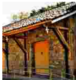
Fig. 250 – Detalhe das mãos francesas em ferro (menores) e em madeira (maiores) da Estação de Rocha Leão. Fonte: CGLucas, 2010.
