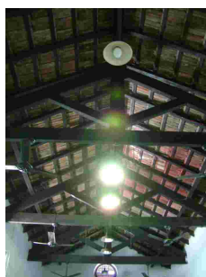
Fig. 252 – Detalhe da estrutura do telhado da Estação de Três Rios - EFL. Fonte: CGLucas, 2010.
