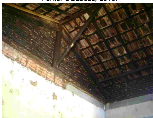
Fig. 278 – Detalhe da estrutura de madeira da Estação de Antonio Rocha. Fonte: CGLucas, 2010.
