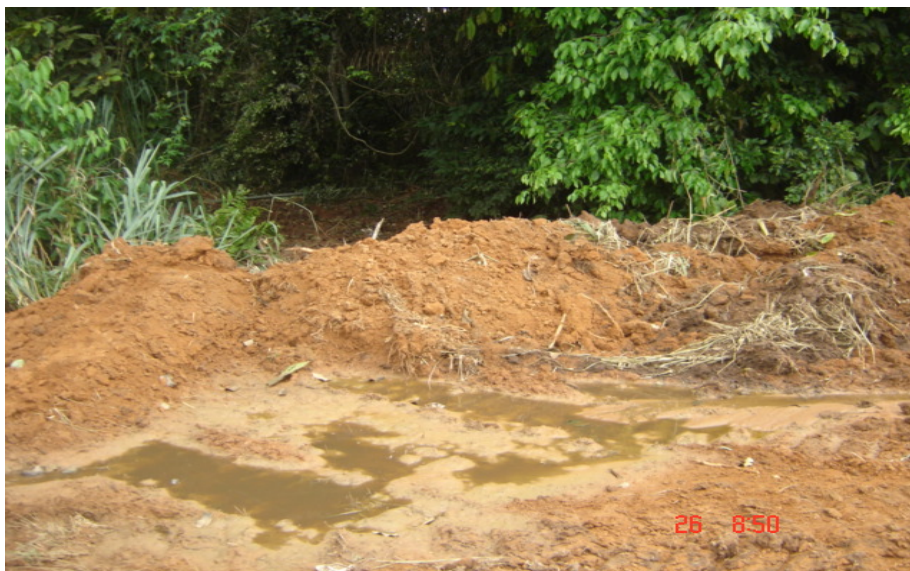
Figura 18: Barreira de contenção provisória. (fev. 2009).
