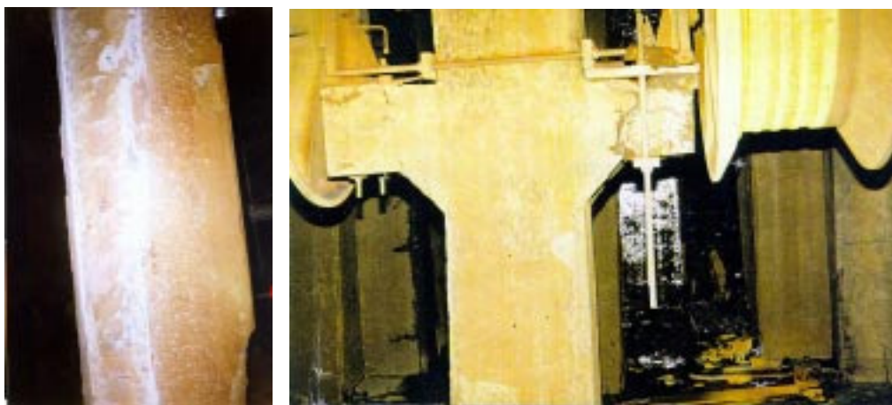
Fotografia 3.5 - Pilares do resfriador de placas, parado para inspeção e recuperação 20
