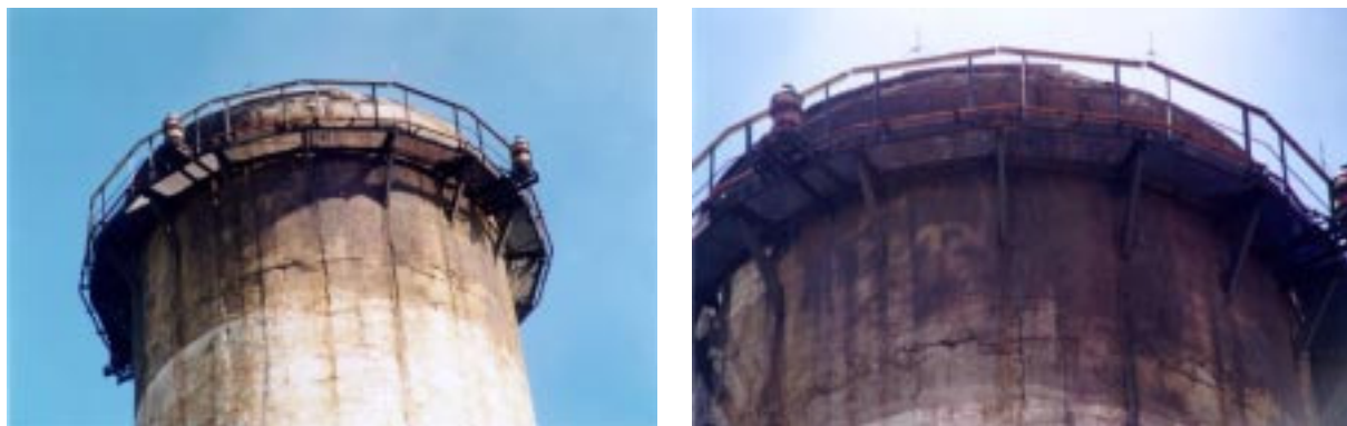
Fotografia 3.6 - Chaminé da sinterização da CST 21
