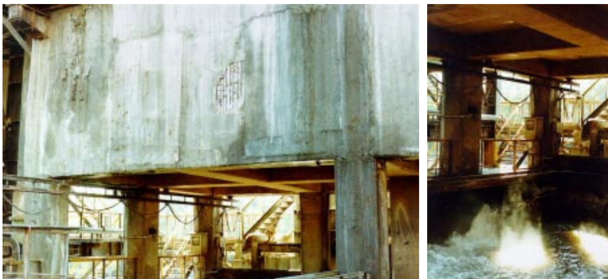
Fotografia 3.3 - Detalhes da torre de resfriamento da granulação de escória 18
