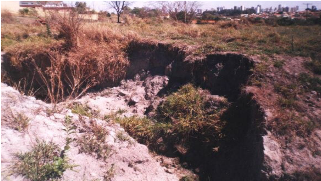
Figura 13 – Queda do talude intermediário na margem esquerda da voçoroca, uma das maiores modificações que ocorreu neste perfil, a queda ocorreu na noite do dia em que se fez a primeira medição. Autor: Roberto R. Alves – 23/04/2002
