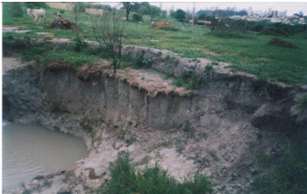
Figura 14 – Início do período chuvoso (outubro), ocorreram novas quedas no talude intermediário em função do solo estarem muito seco na estação anterior e que uma parte do material foi carregado. Nota-se ainda que a vegetação seca inicia sua regeneração. Autor: Roberto R. Alves – 08/10/2002
