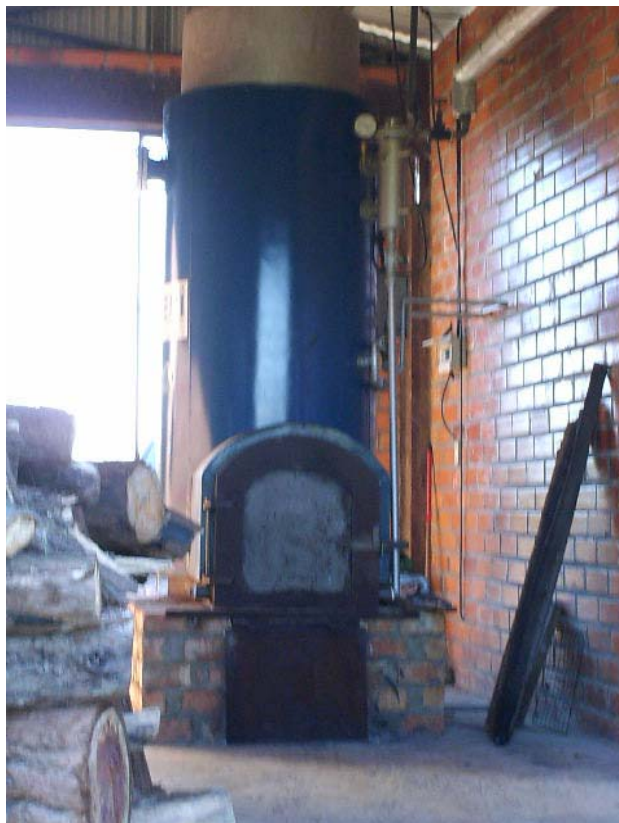
Figura 4.3. Gerador de vapor da unidade industrial – caldeira.
