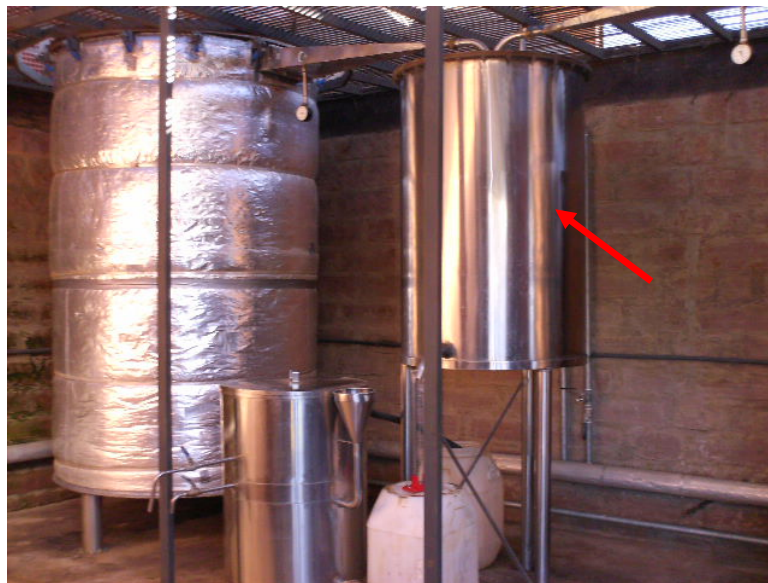
Figura 4.5. Condensador de serpentina da unidade industrial.
