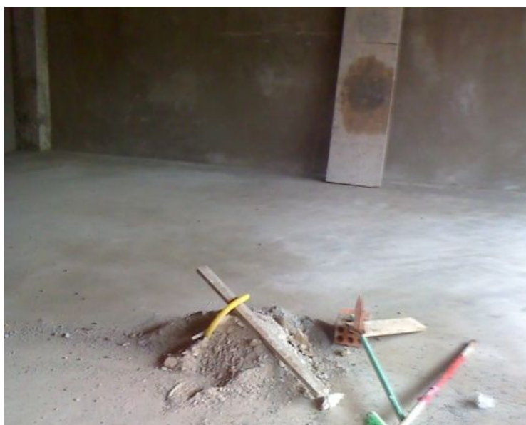
FIGURA 4.1 – GERAÇÃO DE RESÍDUOS DE ARGAMASSA NOS AMBIENTES
