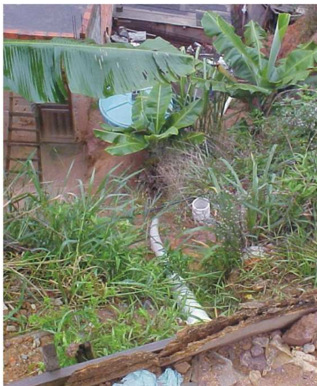
Figura 89: Rede clandestina de esgoto Fonte: Prefeitura Municipal de Santo André, 2005
