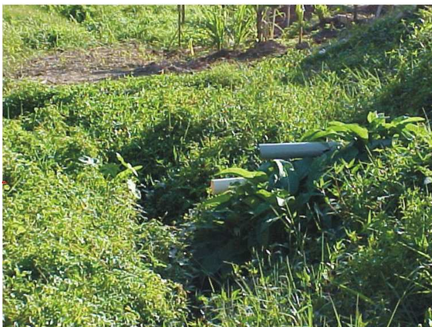
Figura 31: Lançamento de esgoto no córrego. Fonte: Prefeitura Municipal de Santo André, 2005
