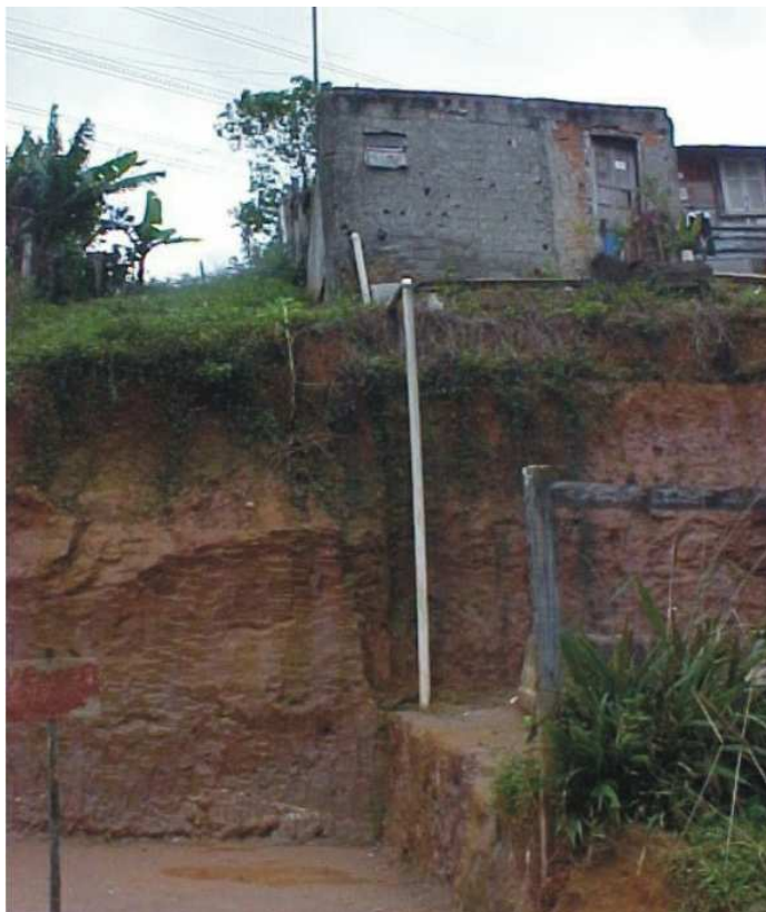
Figura 84: Ligação incorreta de esgoto Fonte: Prefeitura Municipal de Santo André, 2005
