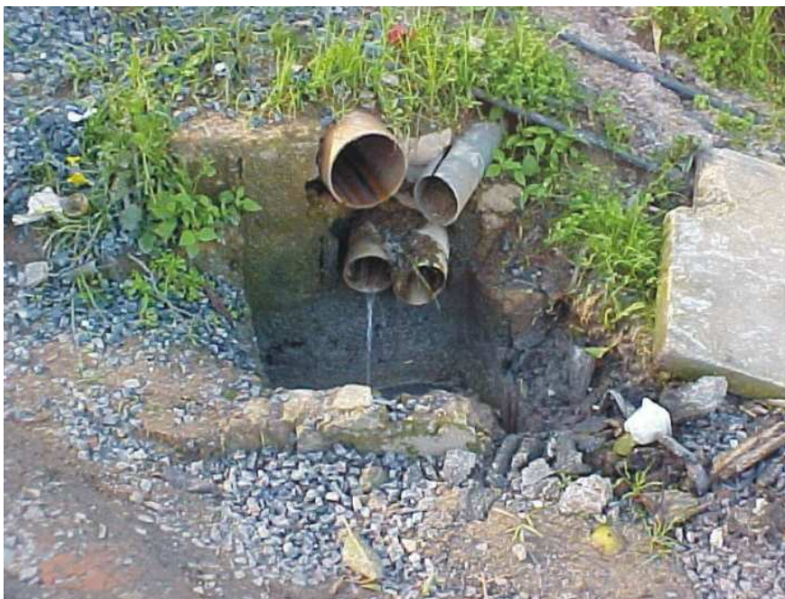
Figura 68: Lançamento de esgoto Fonte: Prefeitura Municipal de Santo André, 2005
