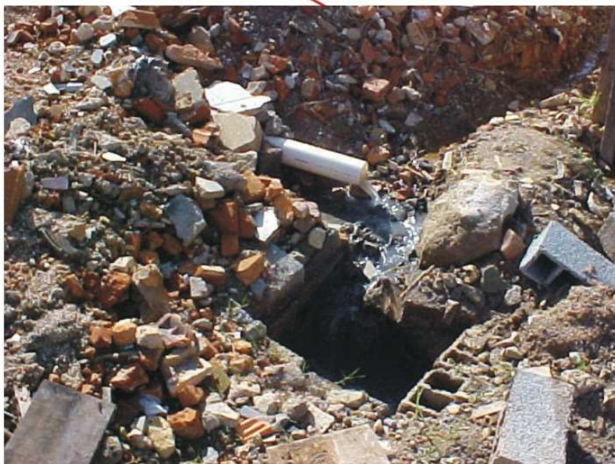
Figura 71: Lançamento de esgoto a céu aberto Fonte: Prefeitura Municipal de Santo André, 2005
