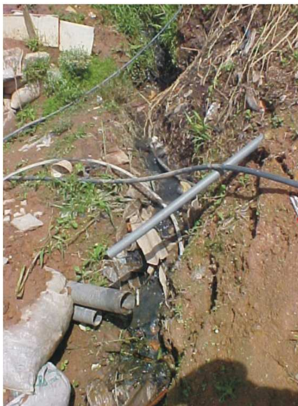
Figura 104: Lançamento de esgoto no córrego Fonte: Prefeitura Municipal de Santo André, 2005
