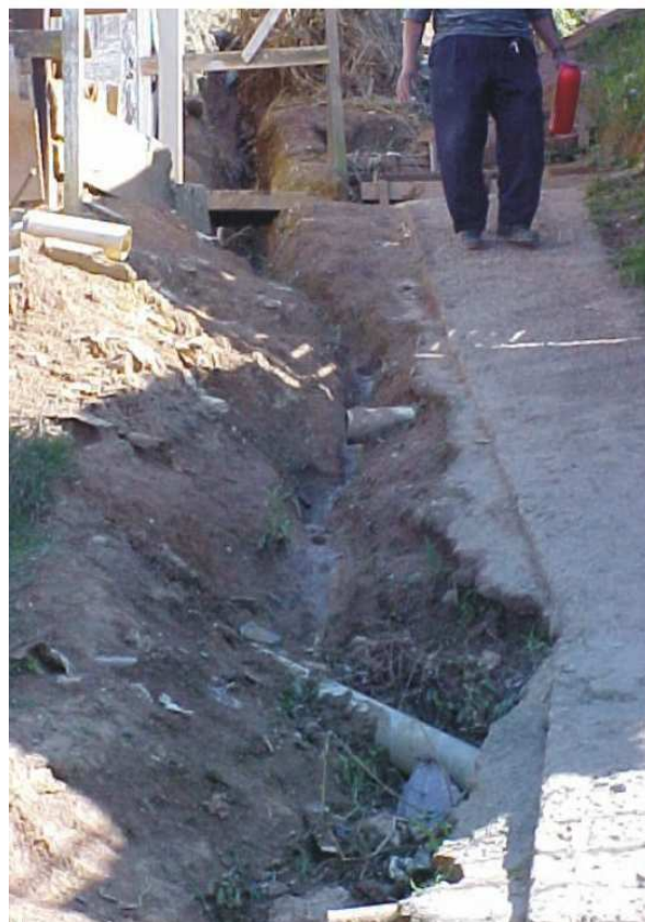
Figura 100: Esgoto lançado a céu aberto entre casas Fonte: Prefeitura Municipal de Santo André, 2005
