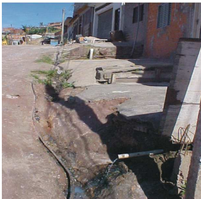
Figura 101: Esgoto lançado na rua Fonte: Prefeitura Municipal de Santo André, 2005
