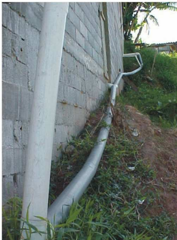
Figura 70: Ligação inadequada de esgoto Fonte: Prefeitura Municipal de Santo André, 2005
