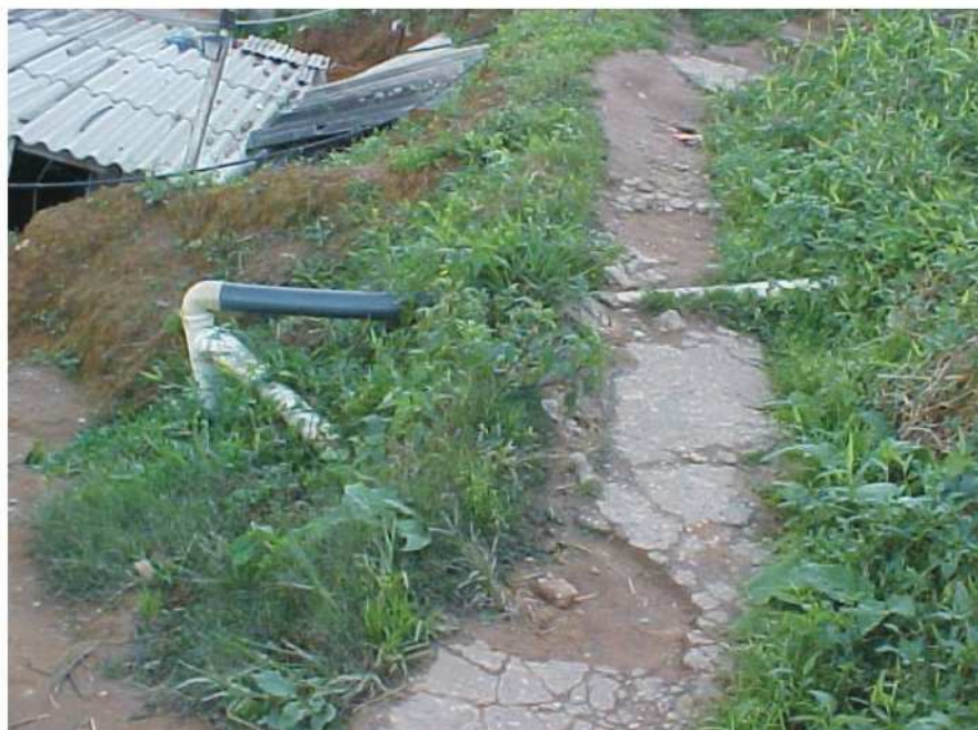
Figura 74: Ligação inadequada de esgoto Fonte: Prefeitura Municipal de Santo André, 2005
