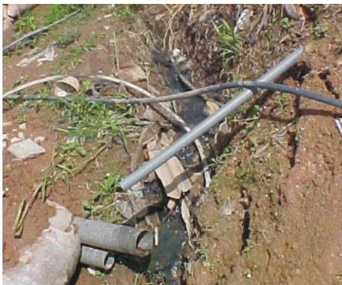
Figura 106: Lançamento de esgoto no córrego Fonte: Prefeitura Municipal de Santo André, 2005
