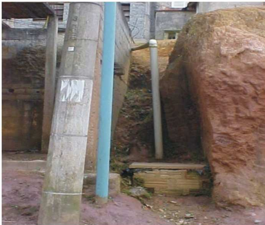
Figura 59: Ligação precária de esgoto Fonte: Prefeitura Municipal de Santo André, 2005
