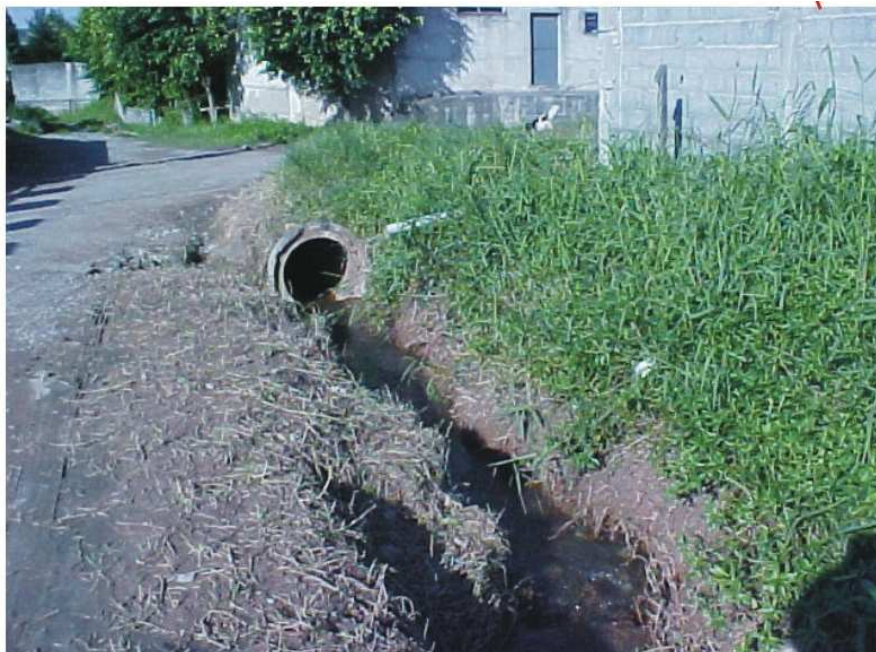
Figura 30: Lançamento de esgoto no córrego. Fonte: Prefeitura Municipal de Santo André, 2005
