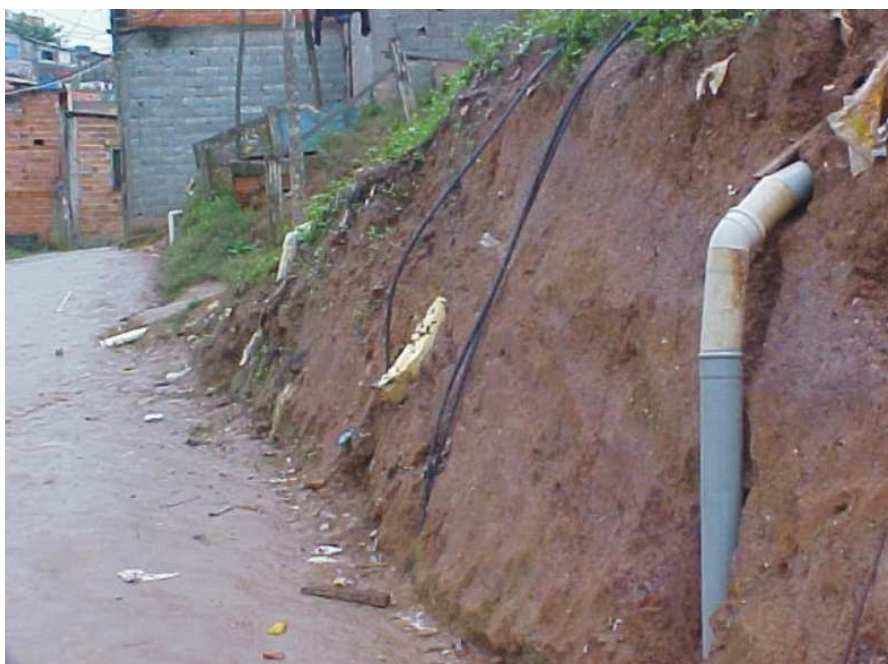
Figura 90: Ramais de esgoto e água inadequados Fonte: Prefeitura Municipal de Santo André, 2005
