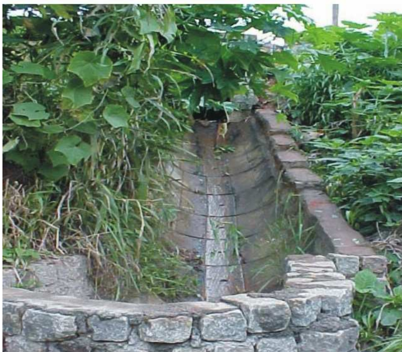
Figura 55: Esgoto coletado na Rua 5B e lançado em vielas no fundo das casas da Rua Caminho dos Vianas até a Rua 8 de Abril. Fonte: Prefeitura Municipal de Santo André, 2005
