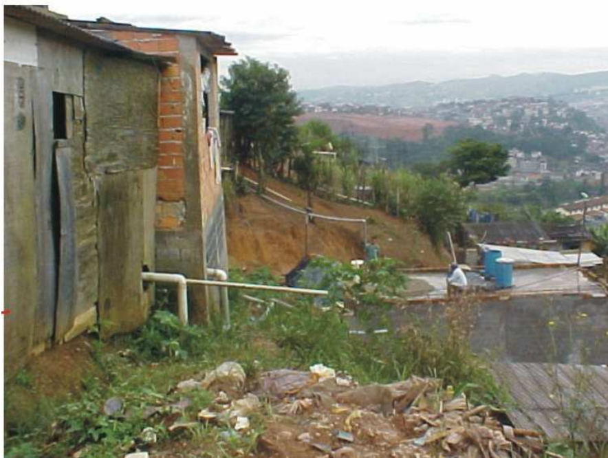
Figura 82: Lançamento de esgoto na encosta Fonte: Prefeitura Municipal de Santo André, 2005
