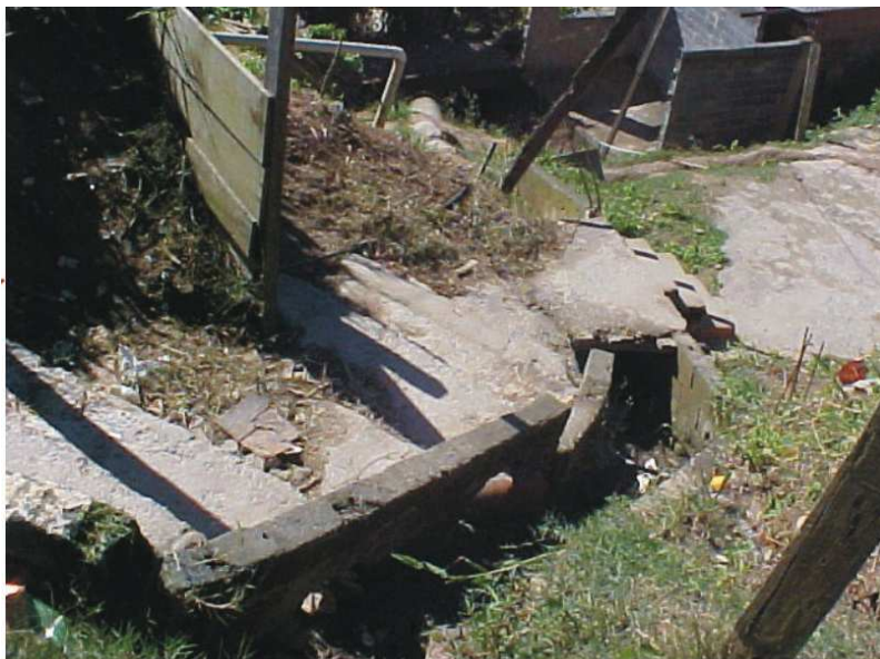
Figura 99: Ponto de lançamento de esgoto na encosta Fonte: Prefeitura Municipal de Santo André, 2005
