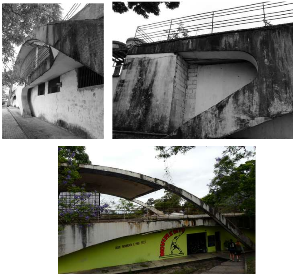
Figuras 145 a 148: Cenas do abandono: sede social a partir da quadra interna, detalhes da estrutura e do fechamento em alvenaria, e vista a partir do acesso. Fonte: acervo da autora, 2009.
