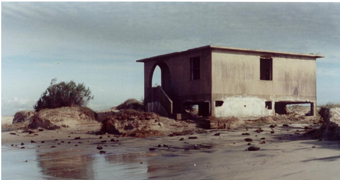
Figura 9 - Casa do faroleiro antes do colapso. Foto de Lauro Calliari.
