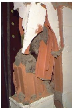
Figura 2.32 - Detalhe da ruptura do graute. Garcia (2000)
